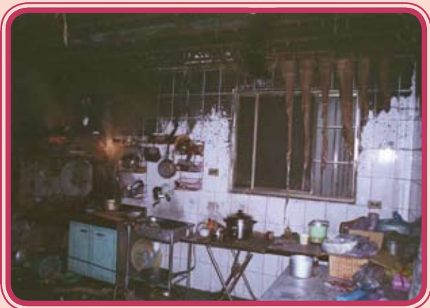
圖1 | 現場1樓僅廚房內部受火流波及燒毀。
