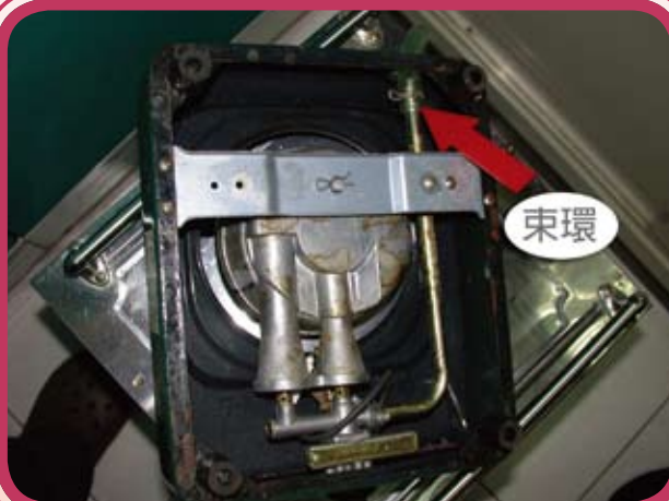
圖6 | 檢視連接爐具進氣口之塑膠軟管接頭是否以金屬束環固定鎖緊，防止脫落造成瓦斯洩漏。
