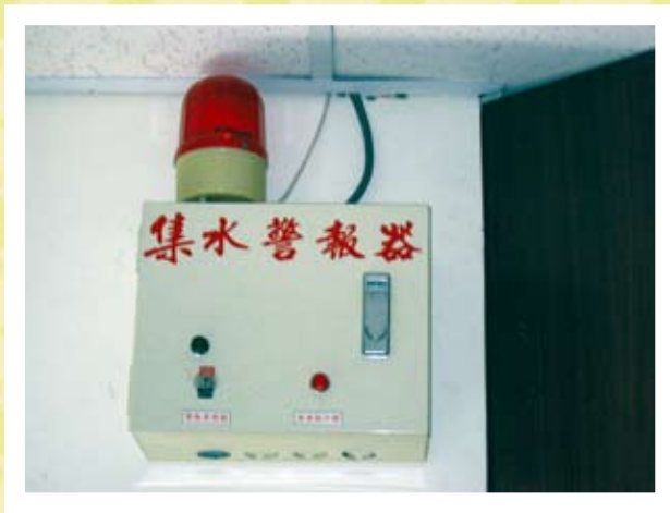
圖5 | 台南市消防局設置集水警報器，監控雨量
