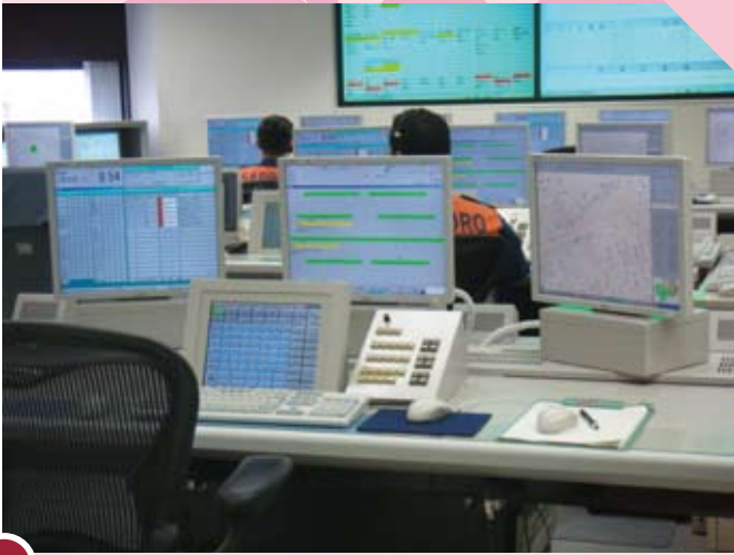
圖7 | 札幌市消防局情報指令中心指令台桌面配置情形
