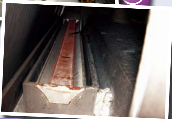
圖5 | 未燒毀酸槽上方照明裝置金屬底座生鏽嚴重。
