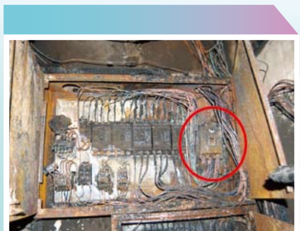
圖3 | 上層配電箱內部西側3相電源總開關之電源側端子座附近燒損較嚴重，且所接續電源線有短路熔斷情形。
