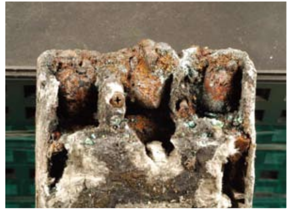
圖5 | 3相電源總開關電源側金屬端子局部燒熔痕跡之巨觀特徵。
