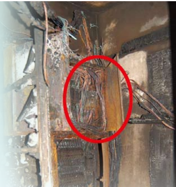
圖2 | 上層配電箱內部西側受燒燬較嚴重，下層配電箱內電源線被覆僅受燻燒，一旁直立式飲水機亦以上半部受燒損情形較嚴重。
