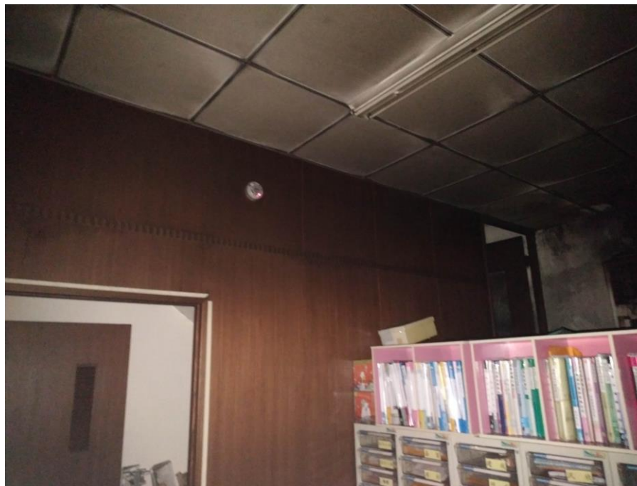
照片 2：住警器裝設位置及鳴動作響情形
