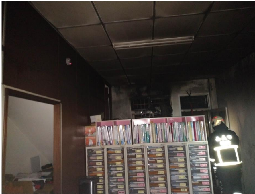
照片 1：1 樓延燒情形
