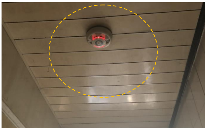
照片 3: 住警器裝設位置及鳴動作響情形
