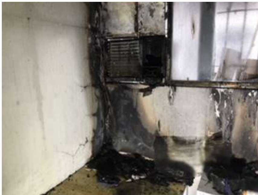
圖一：起火處(冷氣機)
