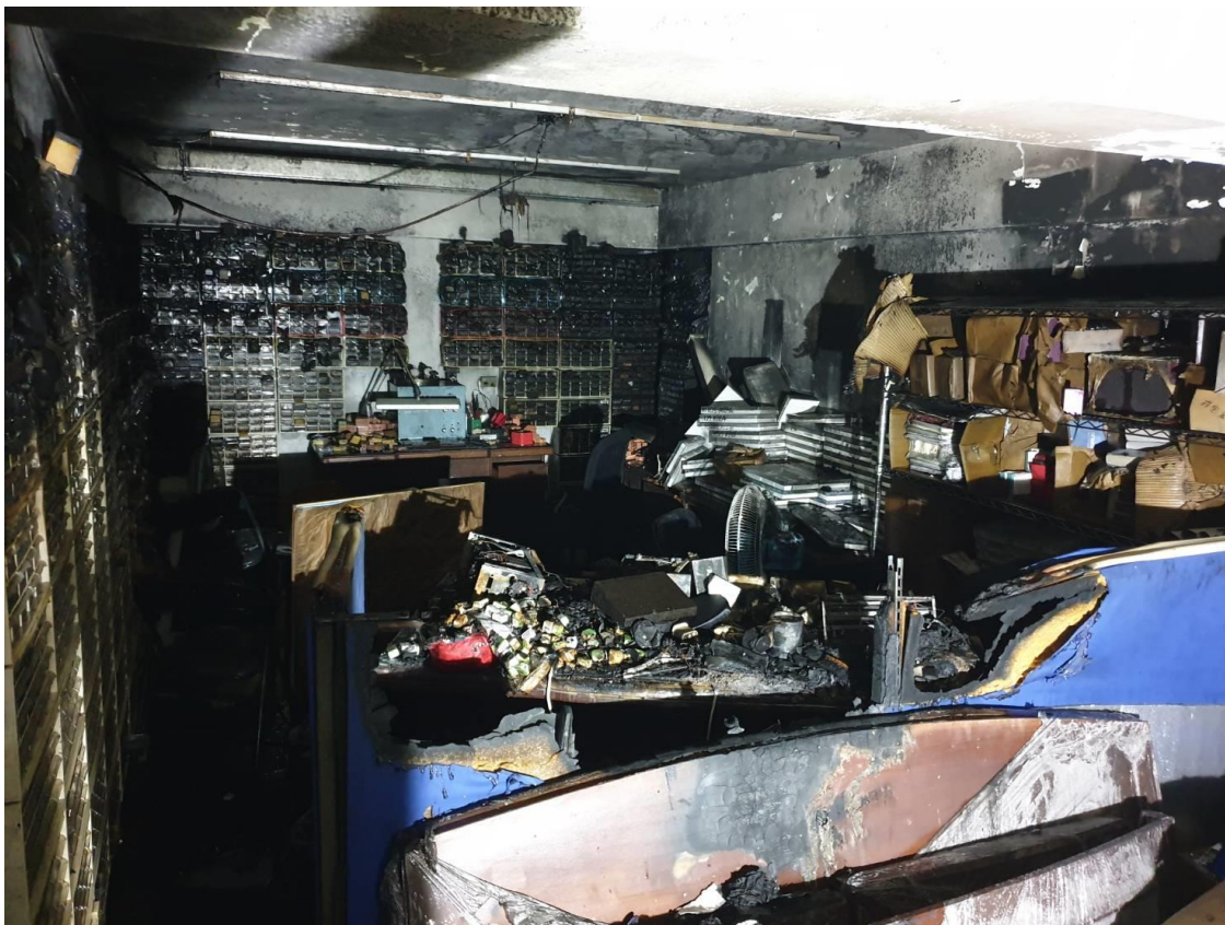
圖一：現場燃燒情形(B1樓儲藏室)
