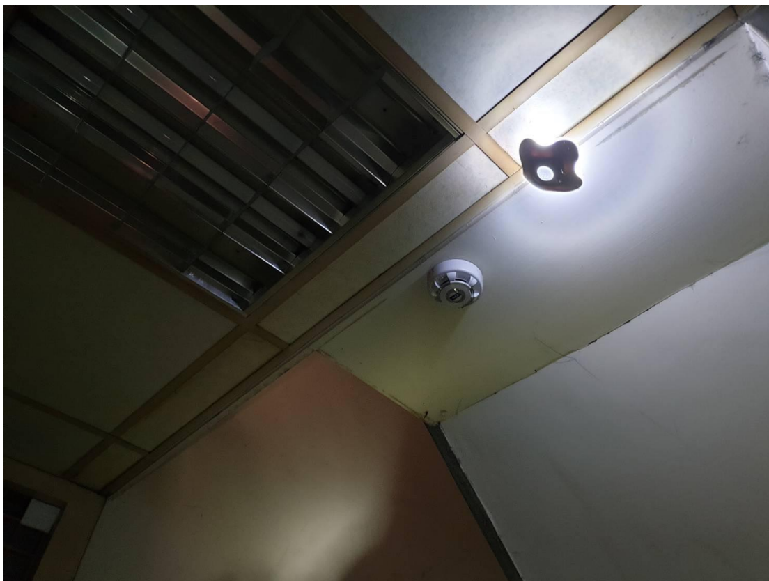
圖五：住警器裝設位置(4樓天花板)
