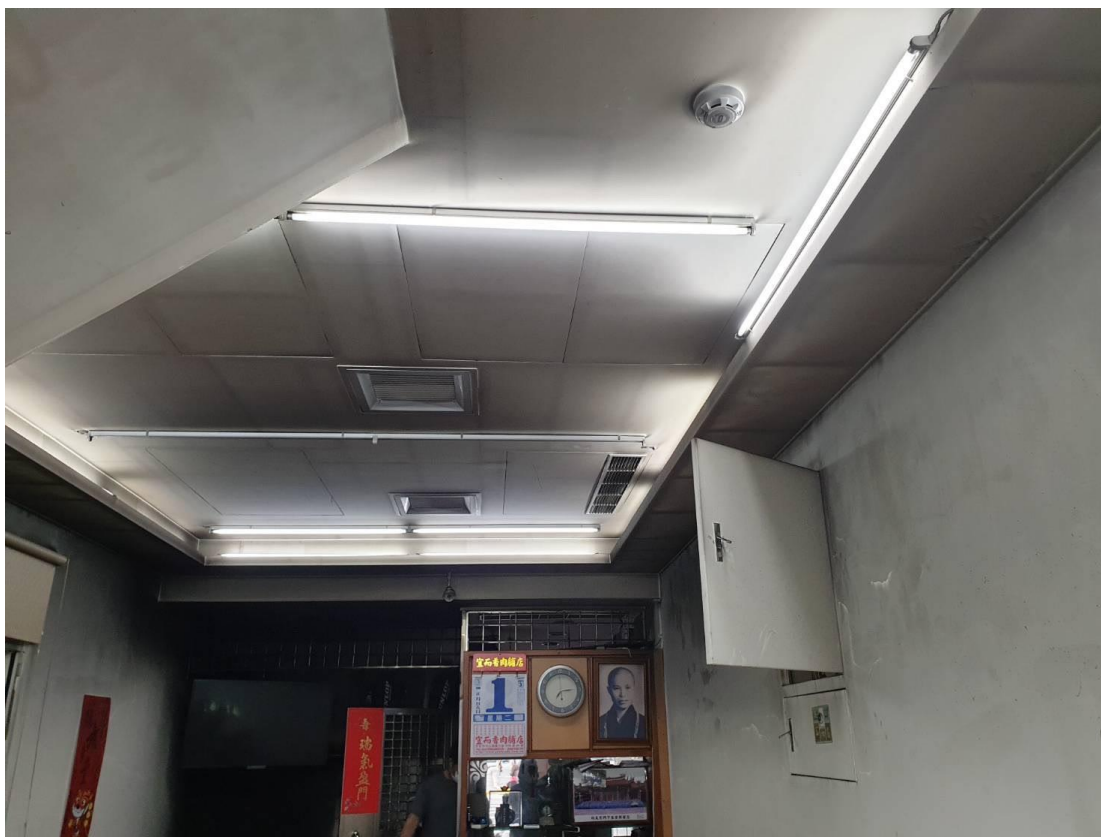
圖二：住警器裝設位置(1樓天花板)
