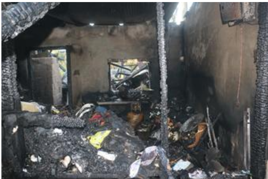
照片 2 室內受燒情形
