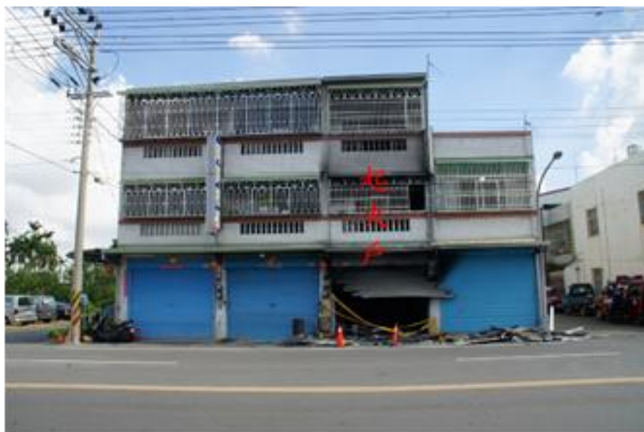
照片 1 建築物外觀受燒情形
