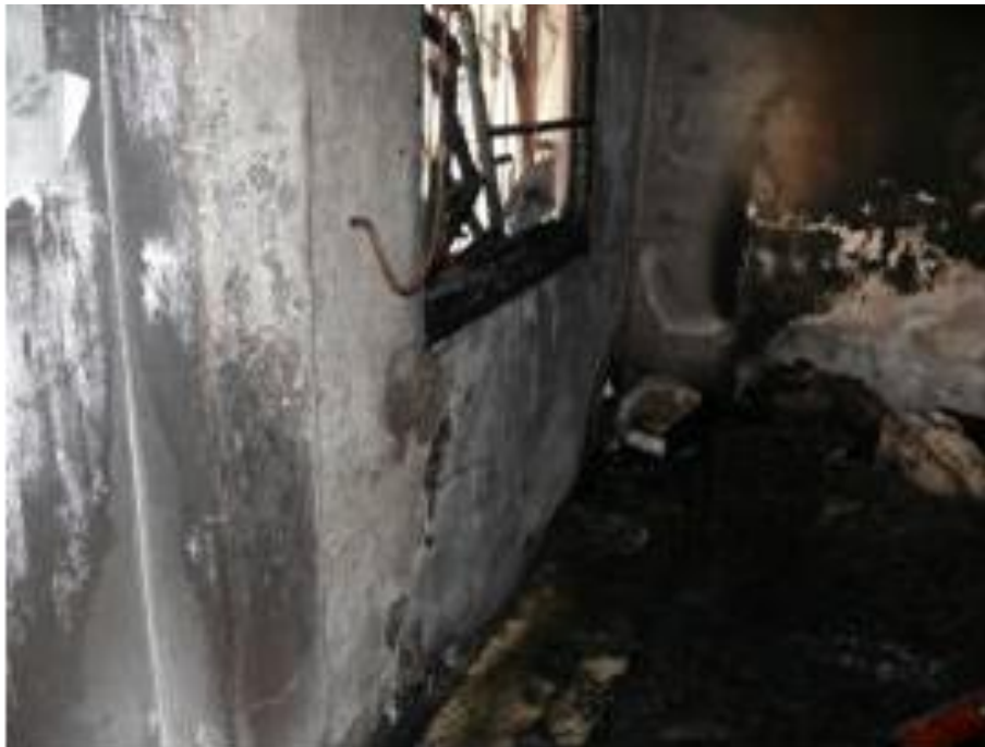
照片 2 室內受燒情形
