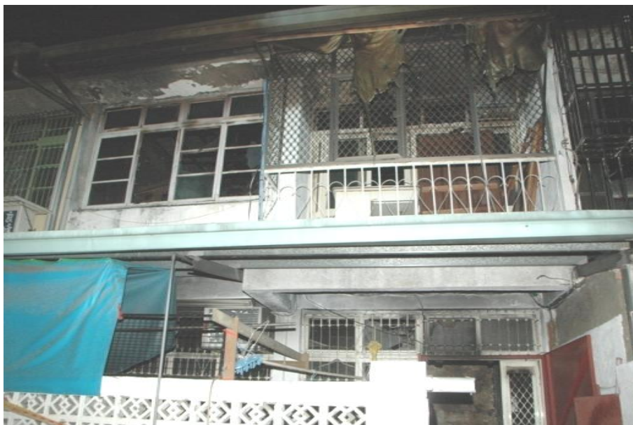
照片 1 建築物外觀受燒情形
