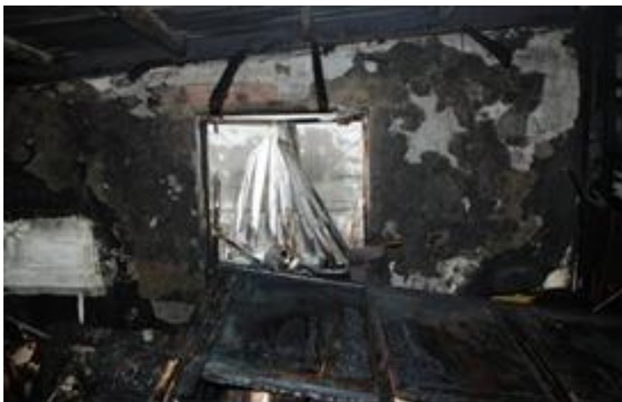
照片 2 室內受燒情形
