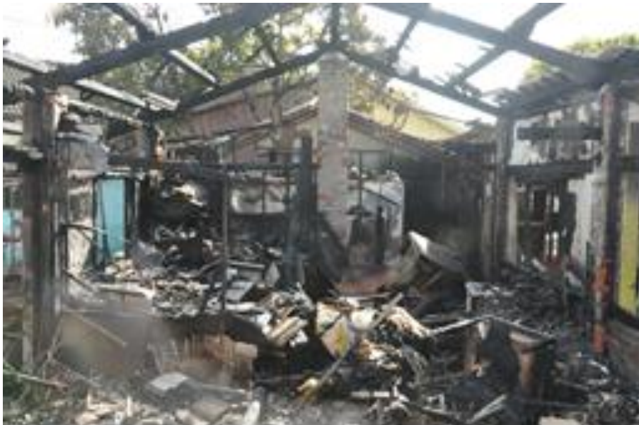
照片 2 室內受燒情形
