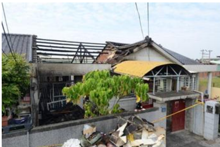
照片 1 建築物外觀受燒情形
