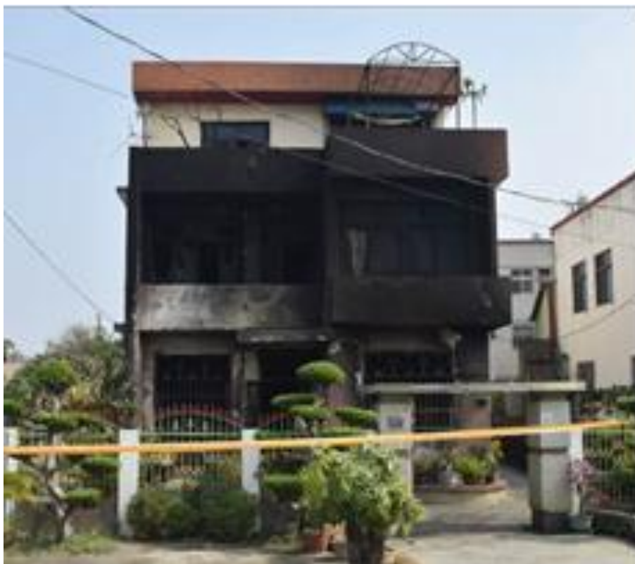
照片 1 建築物外觀受燒情形
