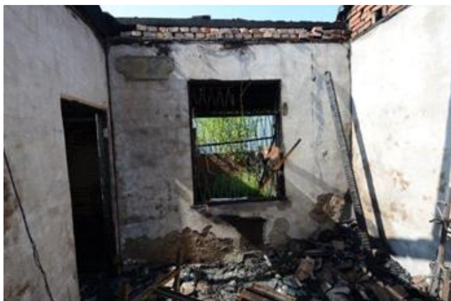
照片 2 室內受燒情形
