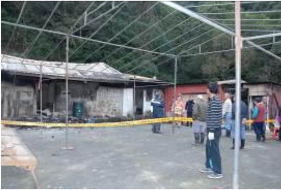
照片 1 建築物外觀受燒情形
