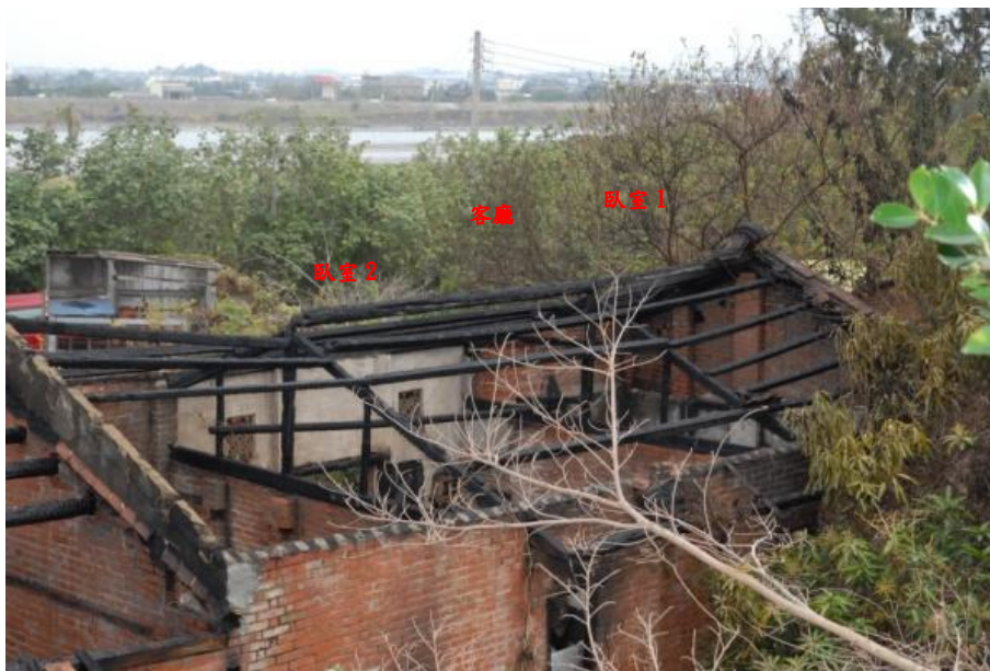
照片 1 建築物外觀受燒情形
