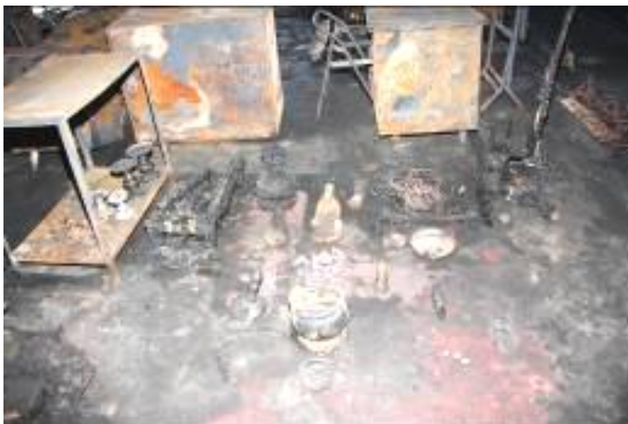
照片 2 供桌神像嚴重碳化、燒失，鐵質環香座嚴重受燒變色，銅質香爐局部嚴重燒熔。
