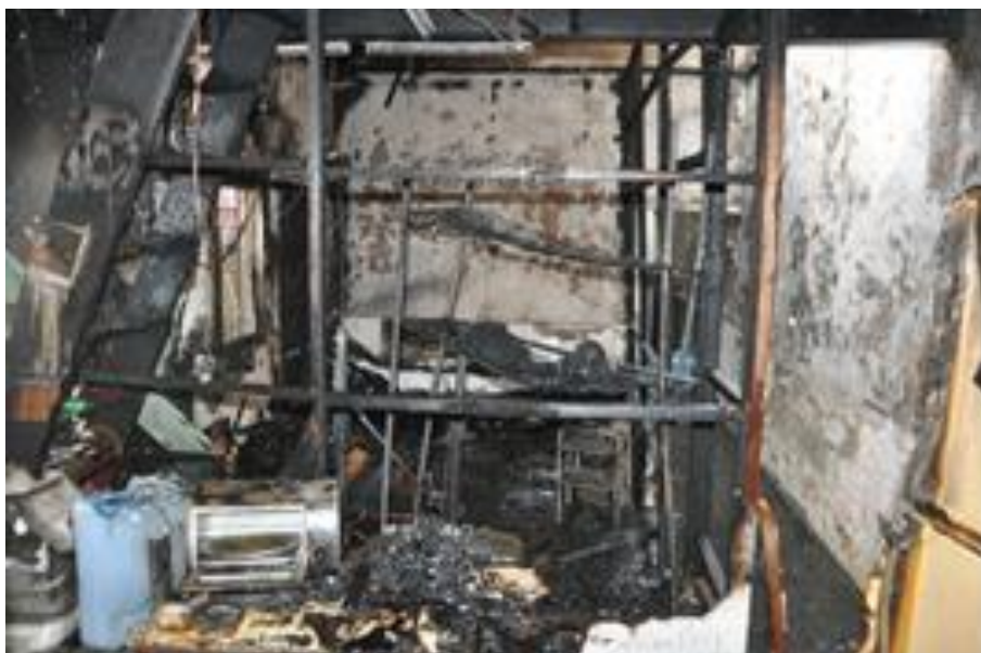
照片 2 室內受燒情形
