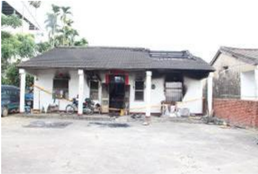
照片 1 建築物外觀受燒情形
