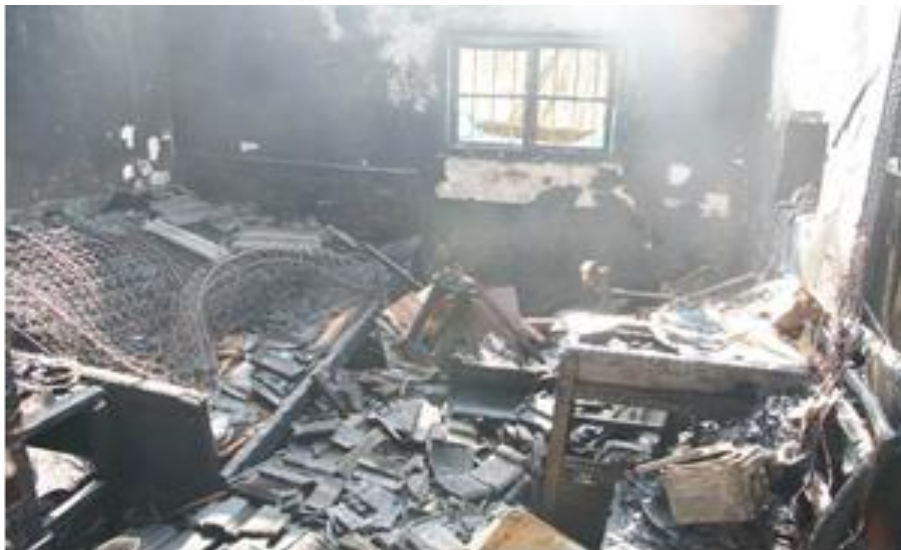
照片 2 室內受燒情形
