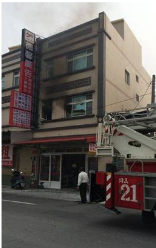
照片 1 建築物外觀受燒情形
