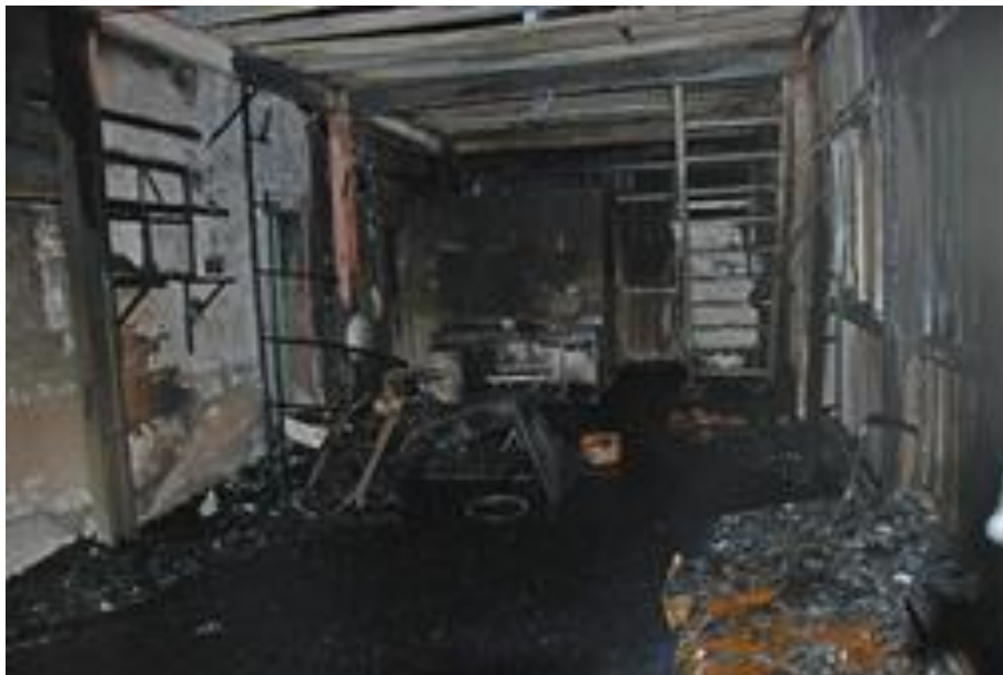
照片 2 室內受燒情形
