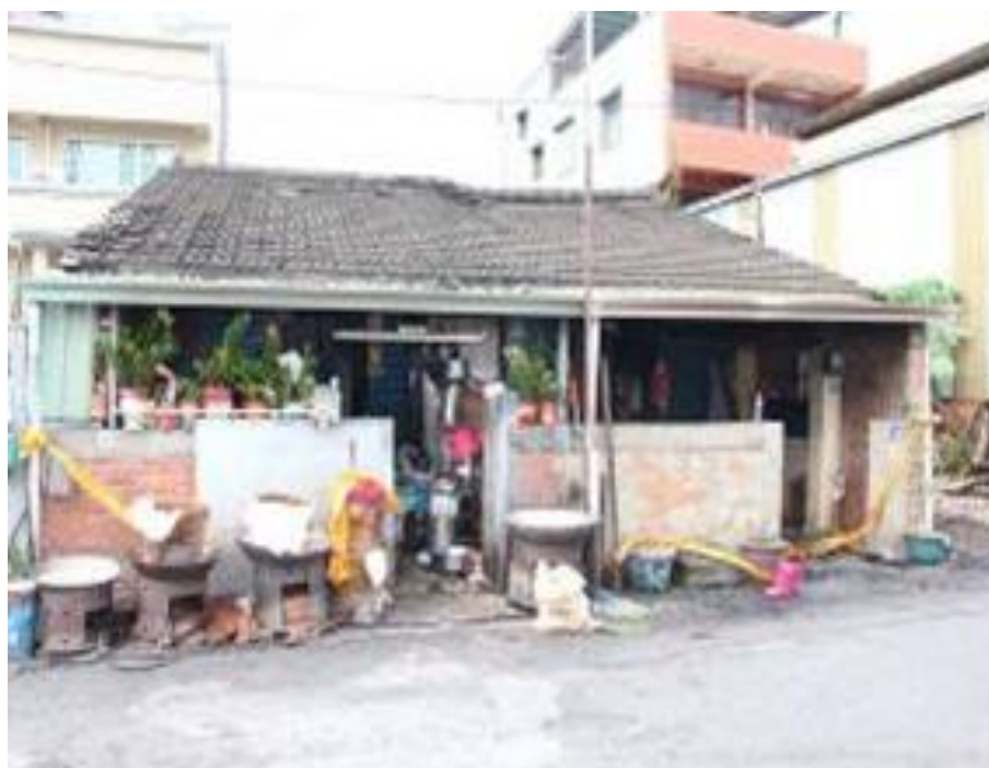
照片 1 建築物外觀受燒情形
