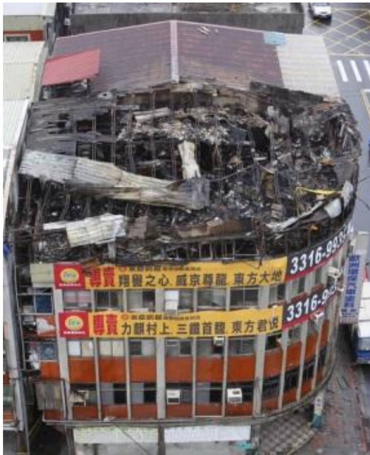
照片 2 4樓頂加蓋受燒後情形
