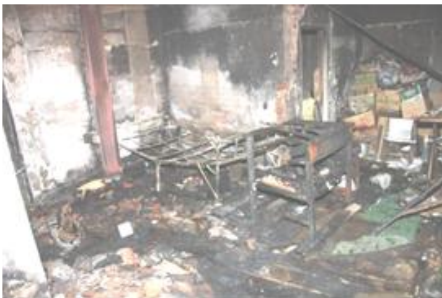
照片 2 室內受燒情形
