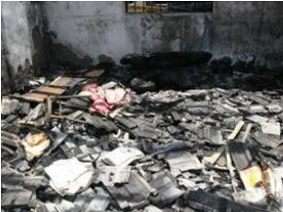
照片 2 室內受燒情形
