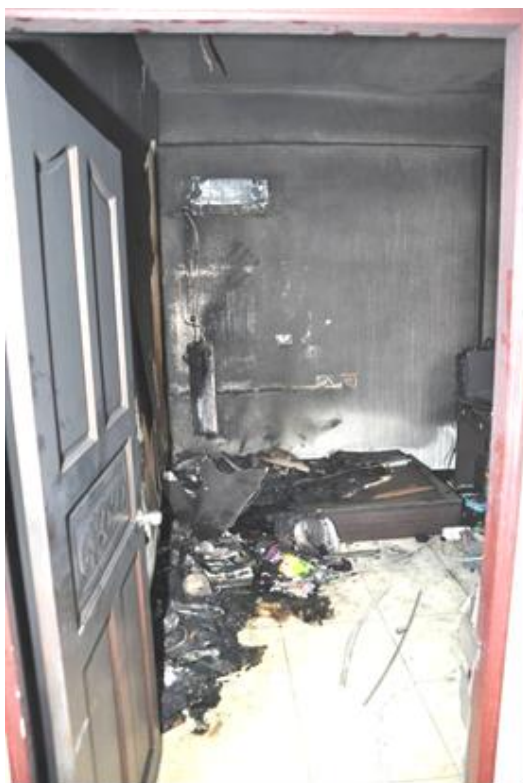
照片 2 室內受燒情形
