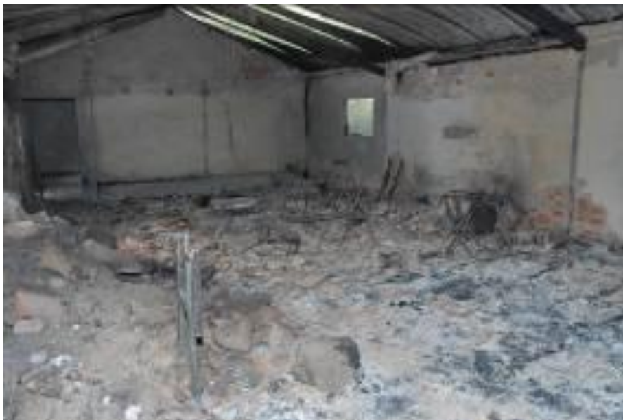
照片 2 室內受燒情形
