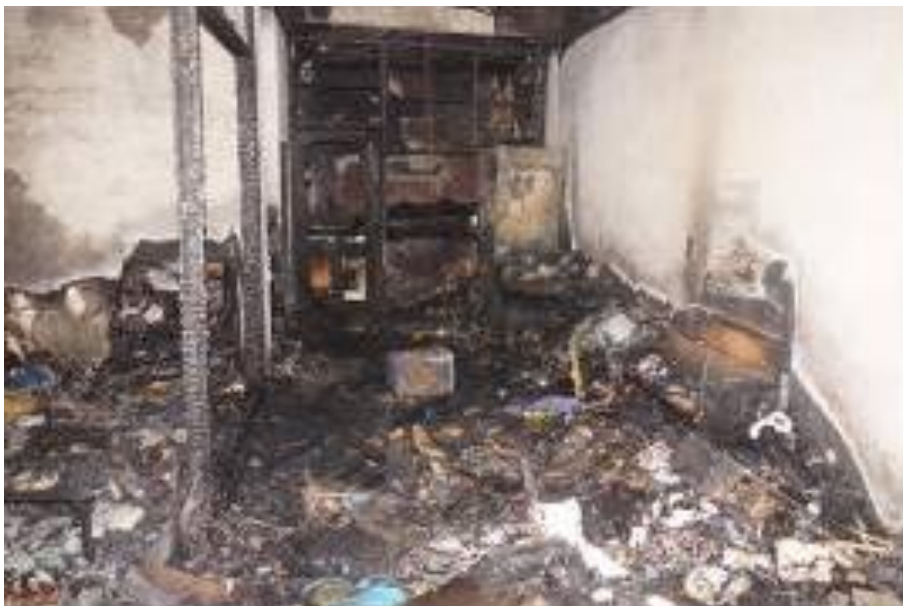
照片 2 室內受燒情形
