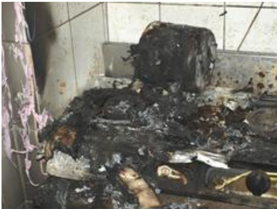
照片 2 瓦斯爐燃燒情形
