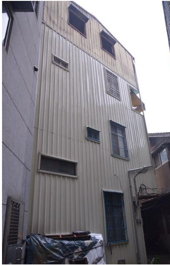
照片 1 建築物外觀受燒情形
