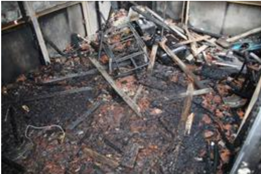
照片 2 室內受燒情形
