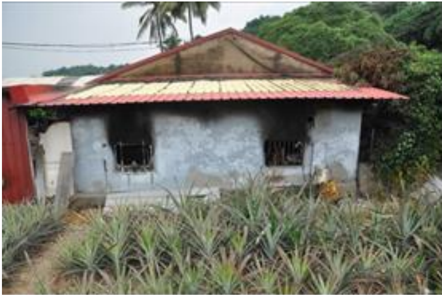
照片 1 建築物外觀受燒情形
