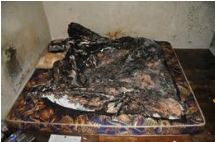
照片 2 室內受燒情形
