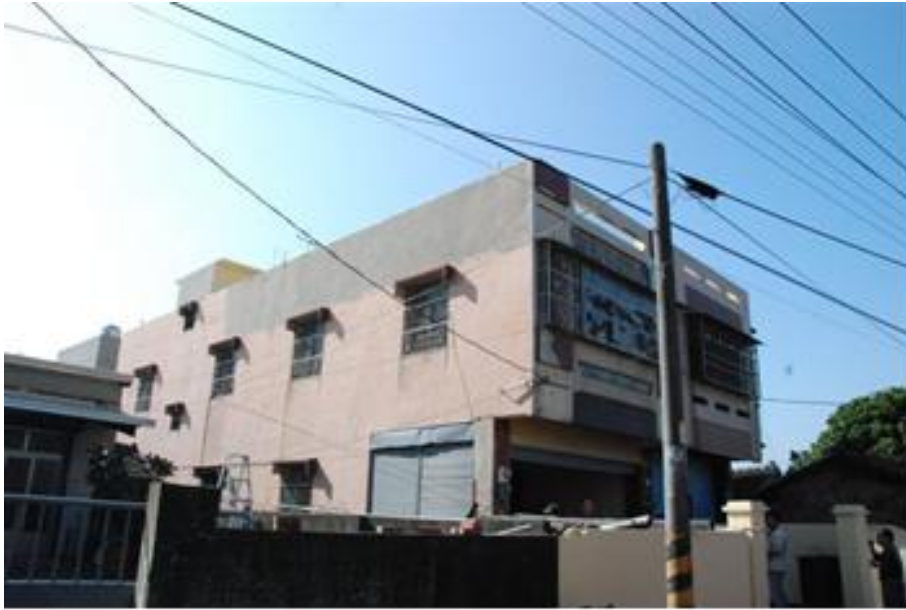
照片 1 建築物外觀受燒情形
