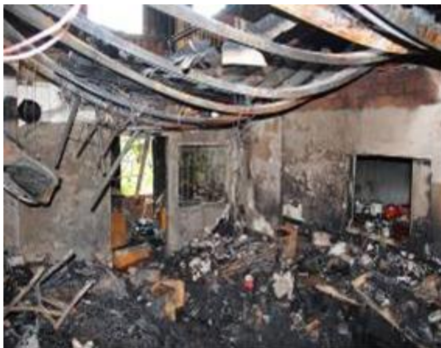
照片 2 室內受燒情形
