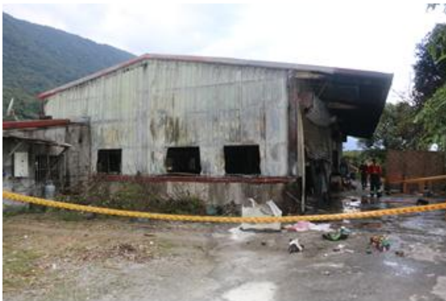
照片 1 建築物外觀受燒情形
