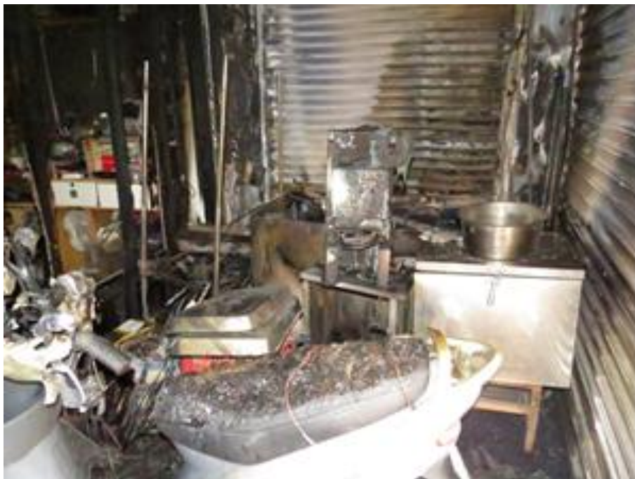
照片 2 室內受燒情形
