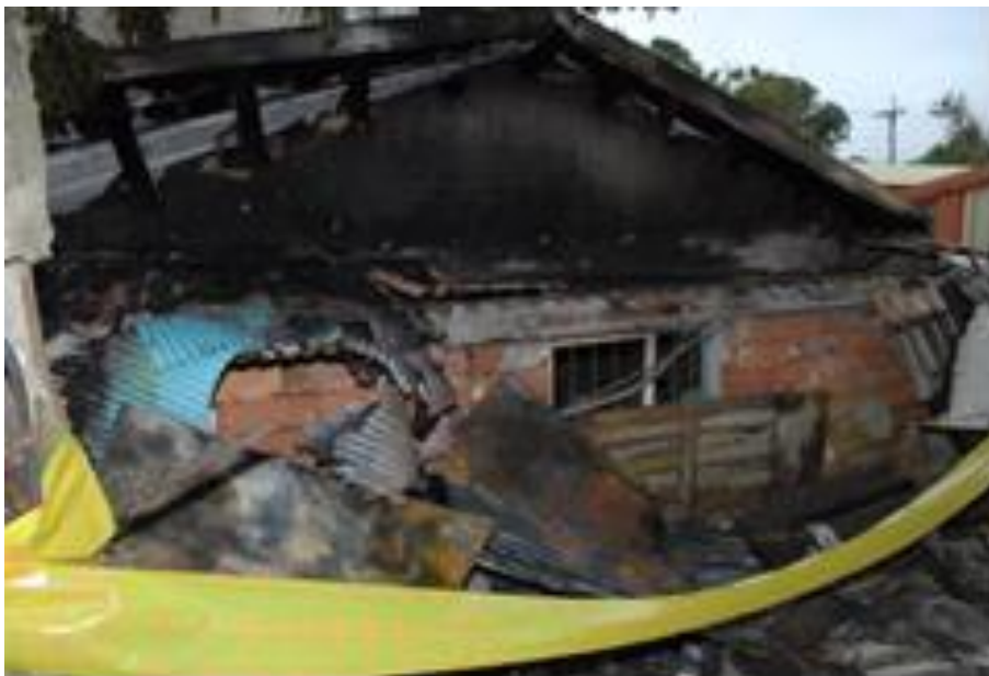
照片 2 室內受燒情形
