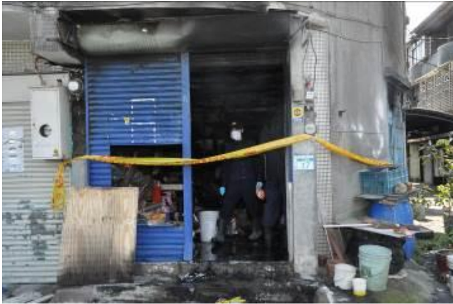
照片 1 建築物外觀受燒情形
