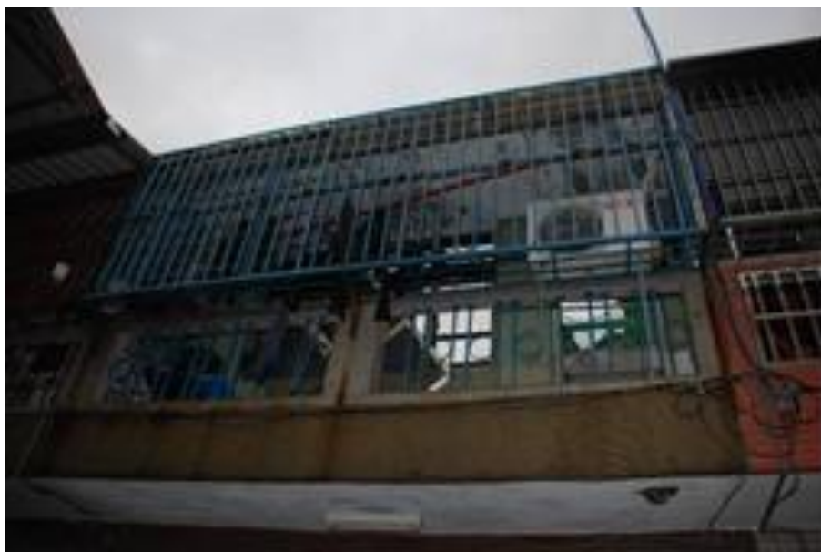
照片 1 建築物外觀受燒情形
