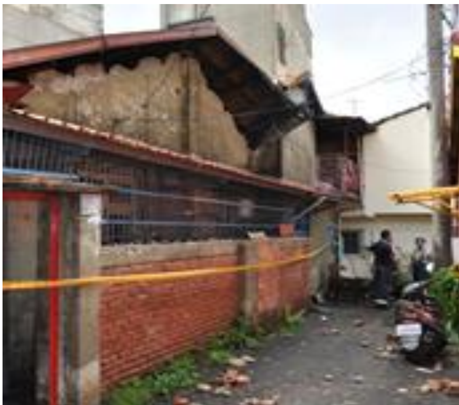
照片 1 建築物外觀受燒情形
