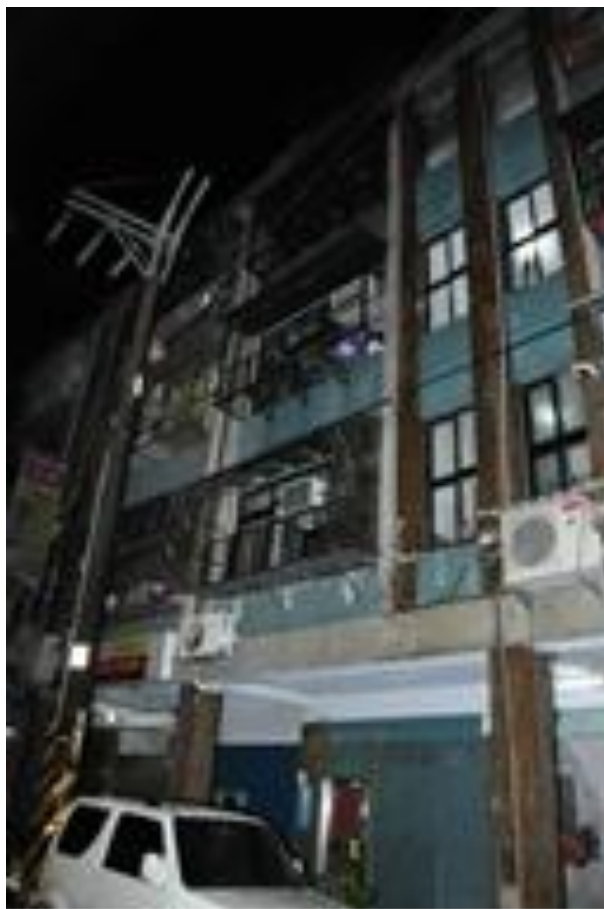
照片 1 建築物外觀受燒情形
