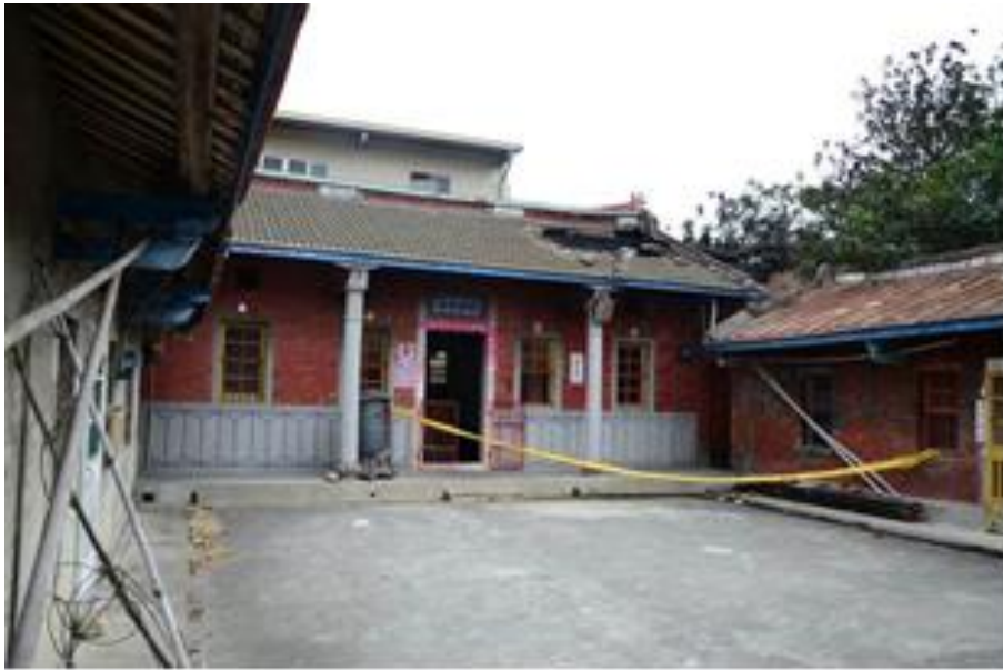
照片 1 建築物外觀受燒情形
