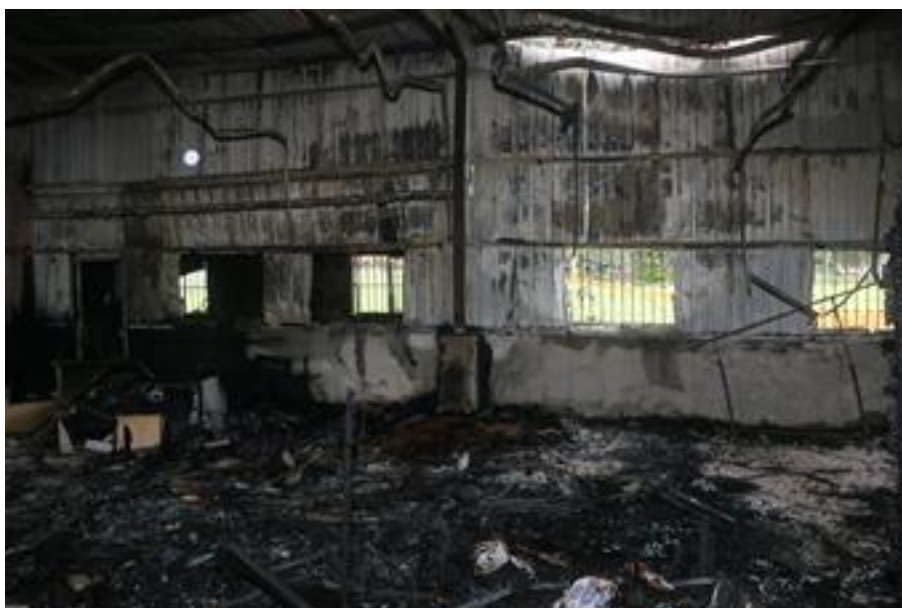
照片 2 室內受燒情形
