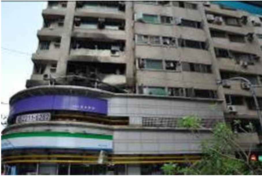
照片 1 建築物外觀受燒情形
