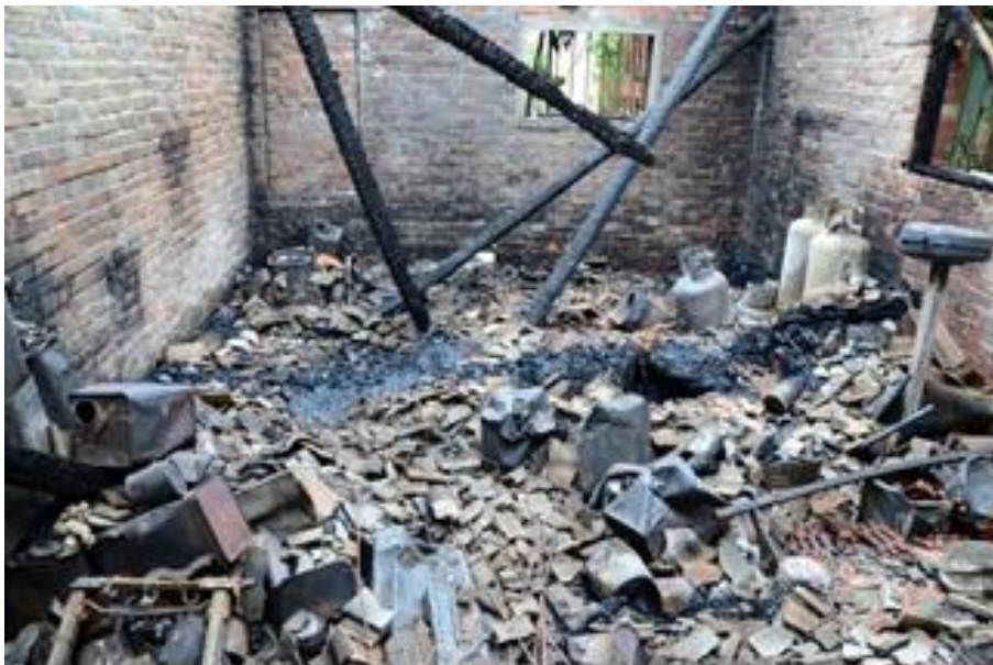
照片 2 室內受燒情形
