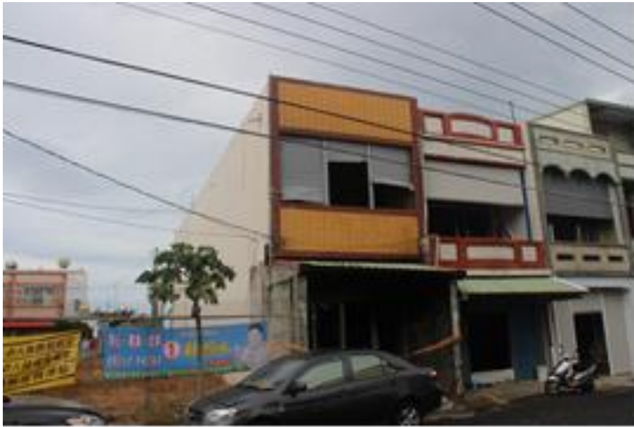
照片 1 建築物外觀受燒情形
