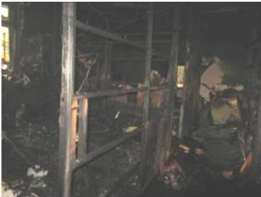
照片 2 室內受燒情形
