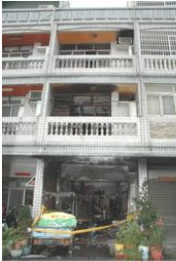
照片 1 建築物外觀受燒情形
