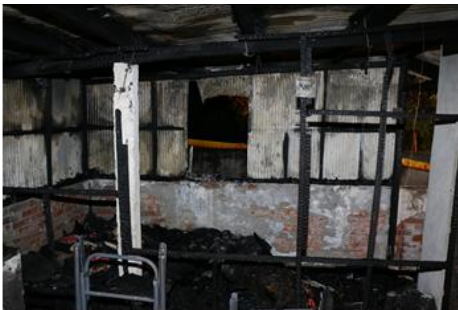
照片 2 室內受燒情形
