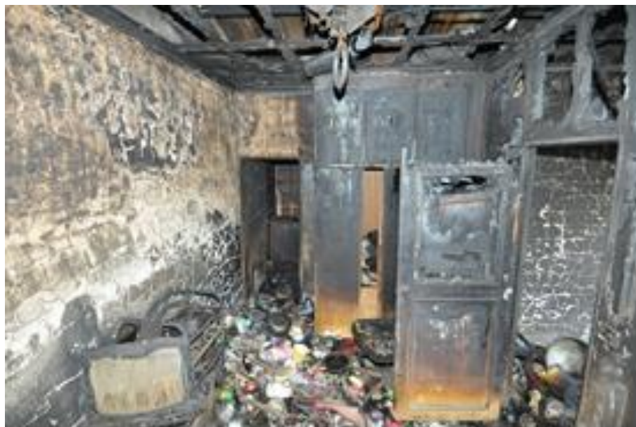
照片 2 室內受燒情形
