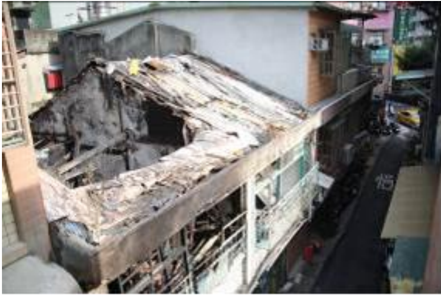
照片 1 建築物外觀受燒情形
