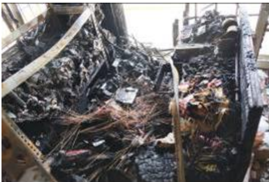
照片 2 室內受燒情形
