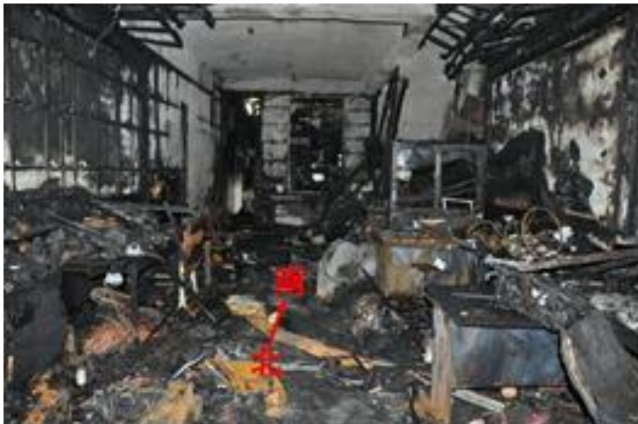
照片 2 室內受燒情形
