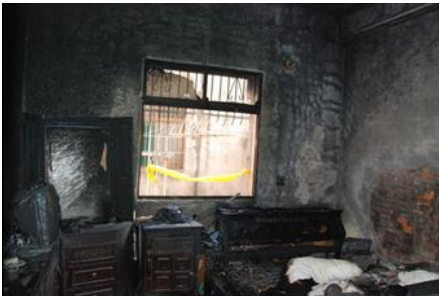
照片 2 室內受燒情形
