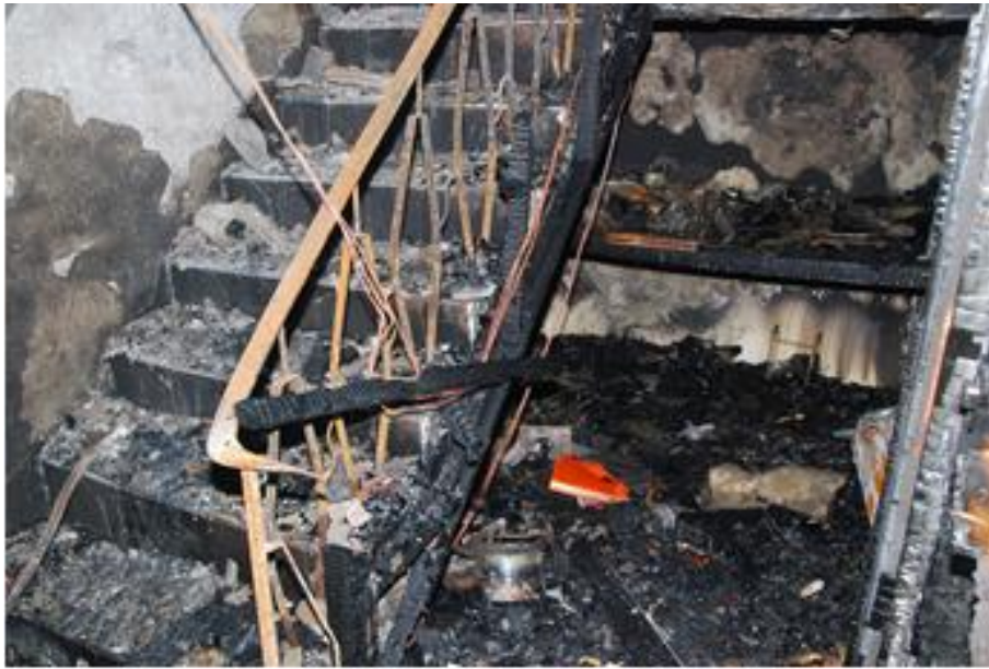
照片 1 梯間下方為儲藏空間，擺放大量可燃物， 形成煙囪效應之延燒路徑
