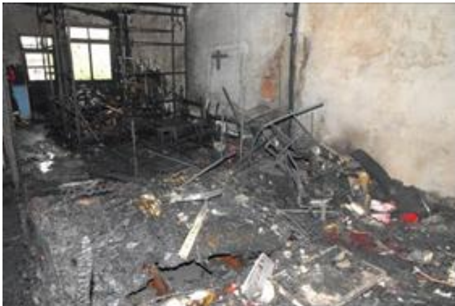
照片 2 室內受燒情形
