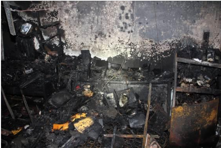
照片 2 室內受燒情形
