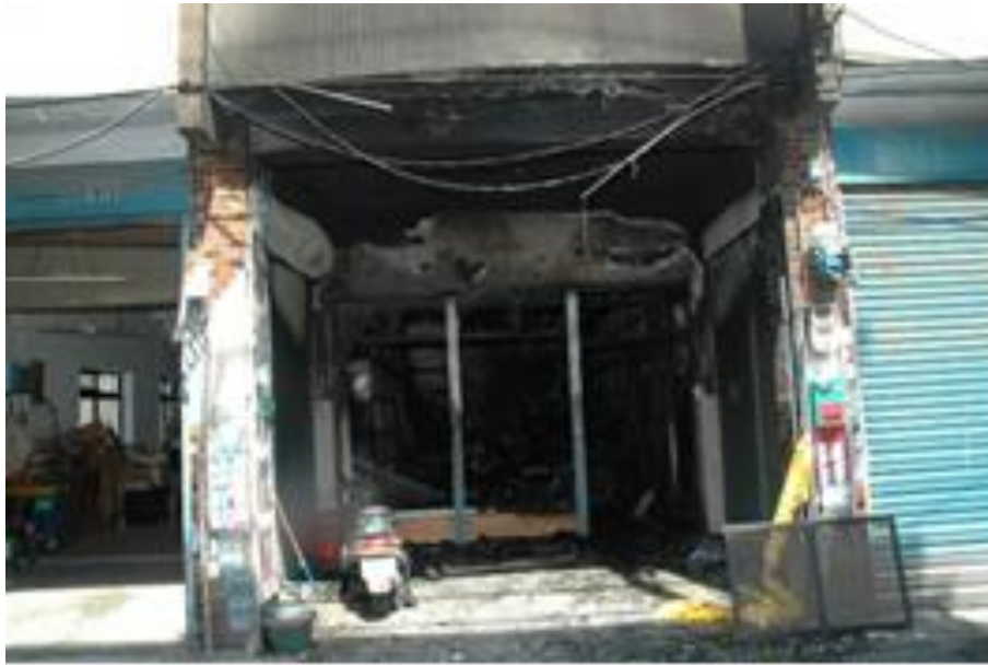
照片 1 建築物外觀受燒情形
