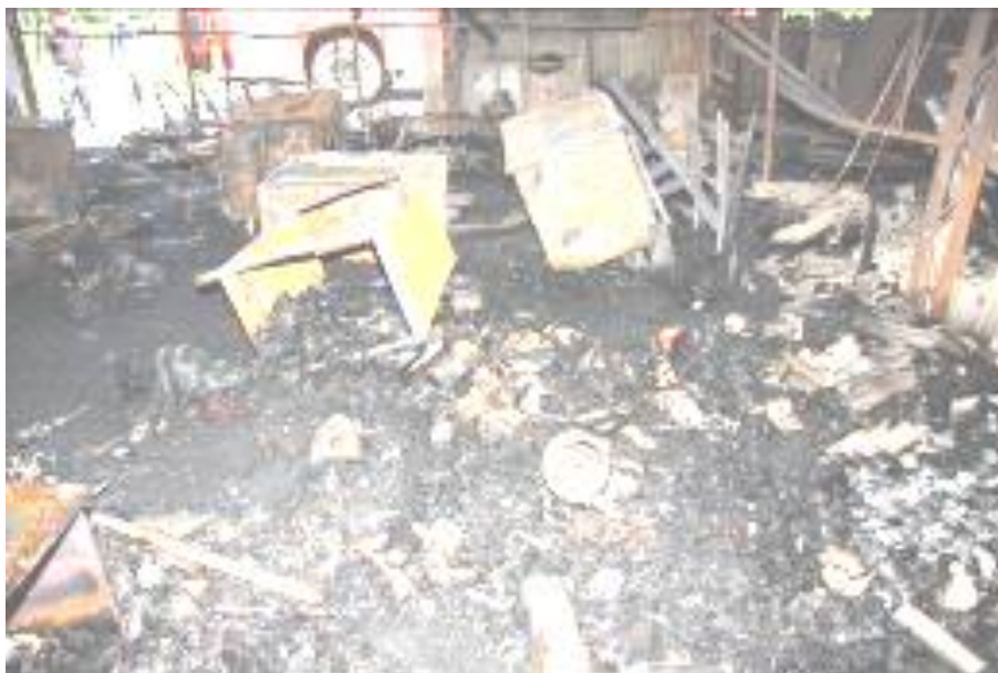
照片 1 建築物外觀受燒情形
