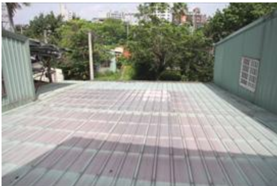
照片 1 建築物屋頂，以西側儲藏室上方附近受燒變色最嚴重。
