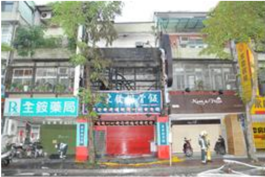
照片 1 建築物外觀受燒情形
