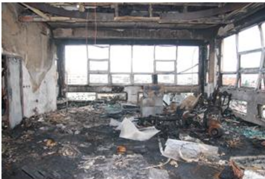
照片 2 室內受燒情形
