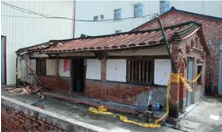
照片 1 建築物外觀受燒情形
