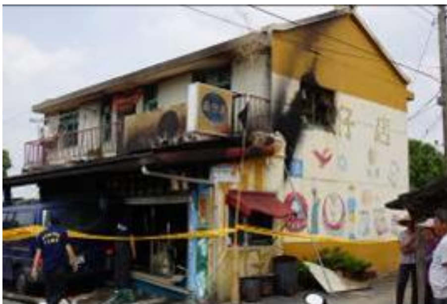
照片 1 建築物外觀受燒情形
