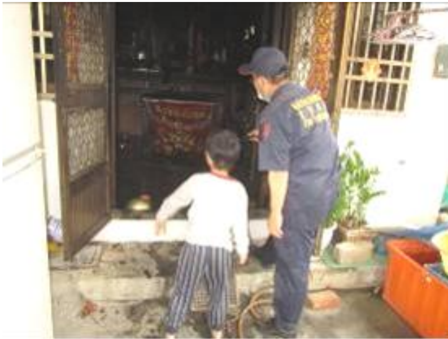
照片 1 建築物外觀受燒情形
