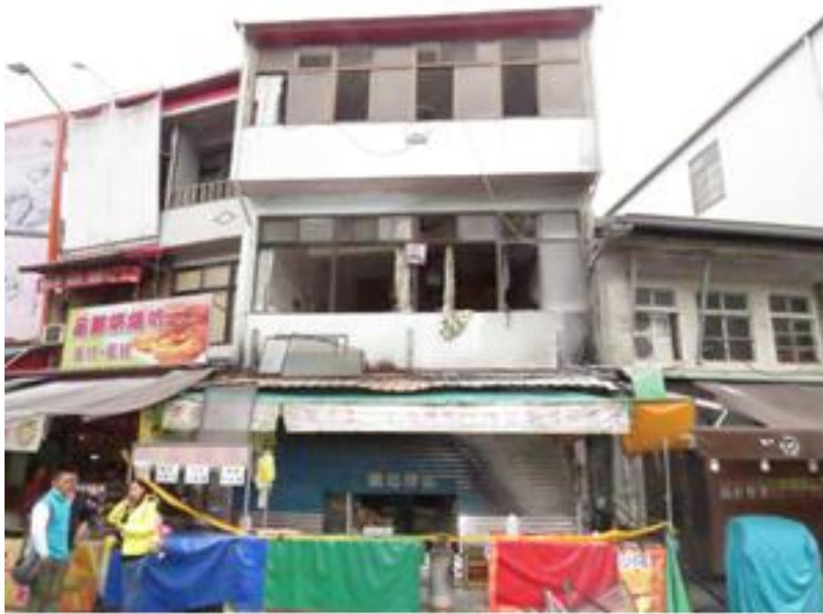
照片 1 建築物外觀受燒情形
