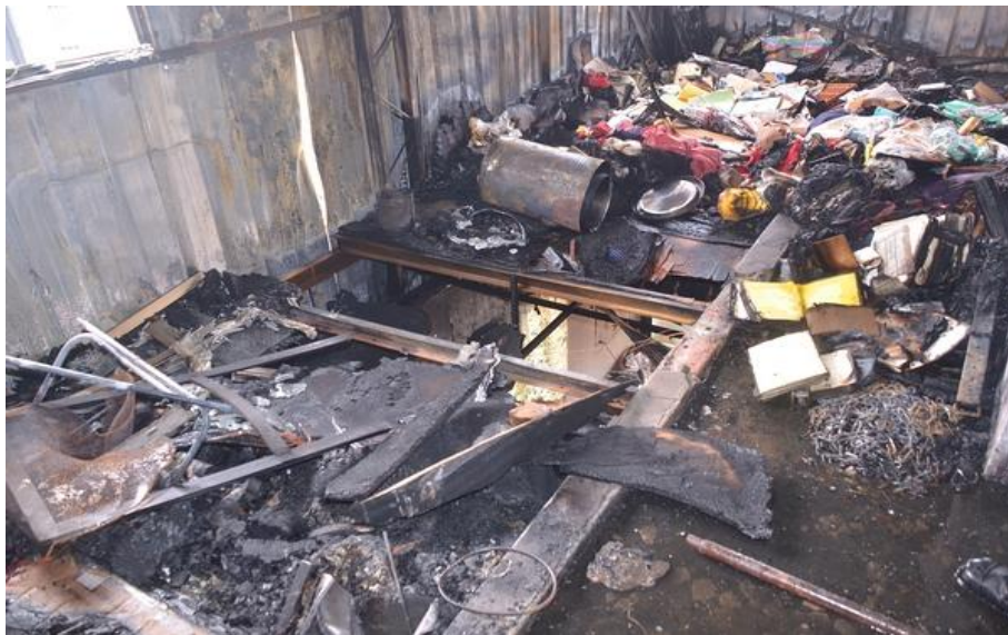
照片 2 3樓神明廳直上方與4樓雜物間相隔之木板呈現由下向上燒穿痕跡，另檢視4樓雜物間呈現由燒穿處向四周燒燬痕跡
