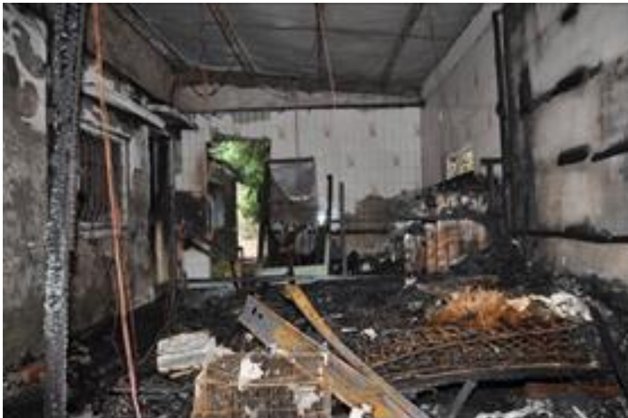
照片 2 室內受燒情形
