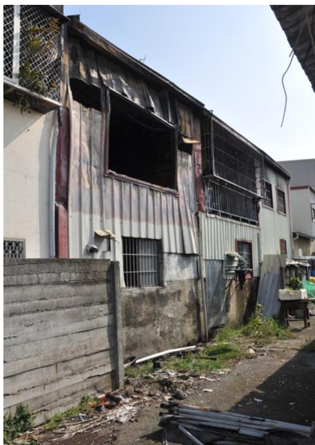
照片 1 建築物外觀受燒情形
