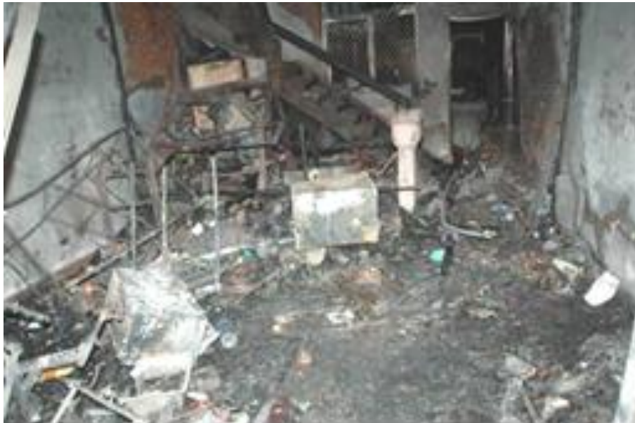
照片 2 室內受燒情形
