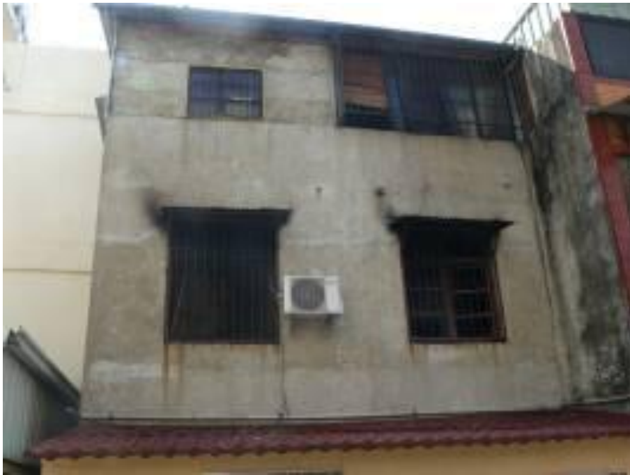
照片 1 建築物外觀受燒情形
