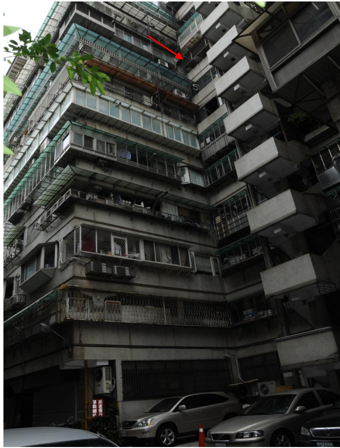
照片 1 建築物外觀受燒情形
