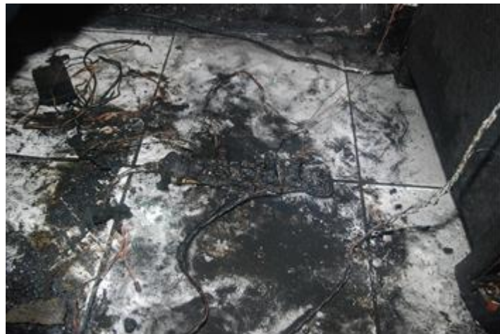
照片 2 清理起火處後發現該處有置放一條延長線，上方插滿檯燈、熱水瓶、電腦、電話等電器用品，緊鄰之沙發燒燬、燒失情形嚴重
