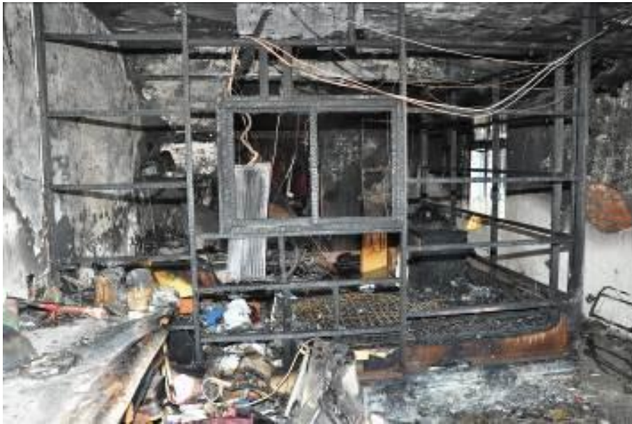
照片 2 室內受燒情形
