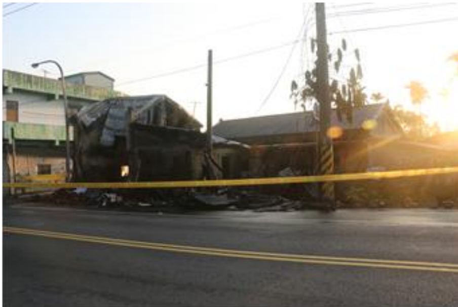
照片 1 建築物外觀受燒情形
