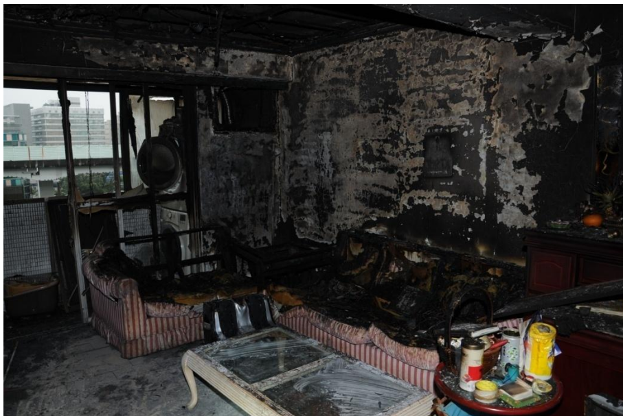
照片 2 室內受燒情形
