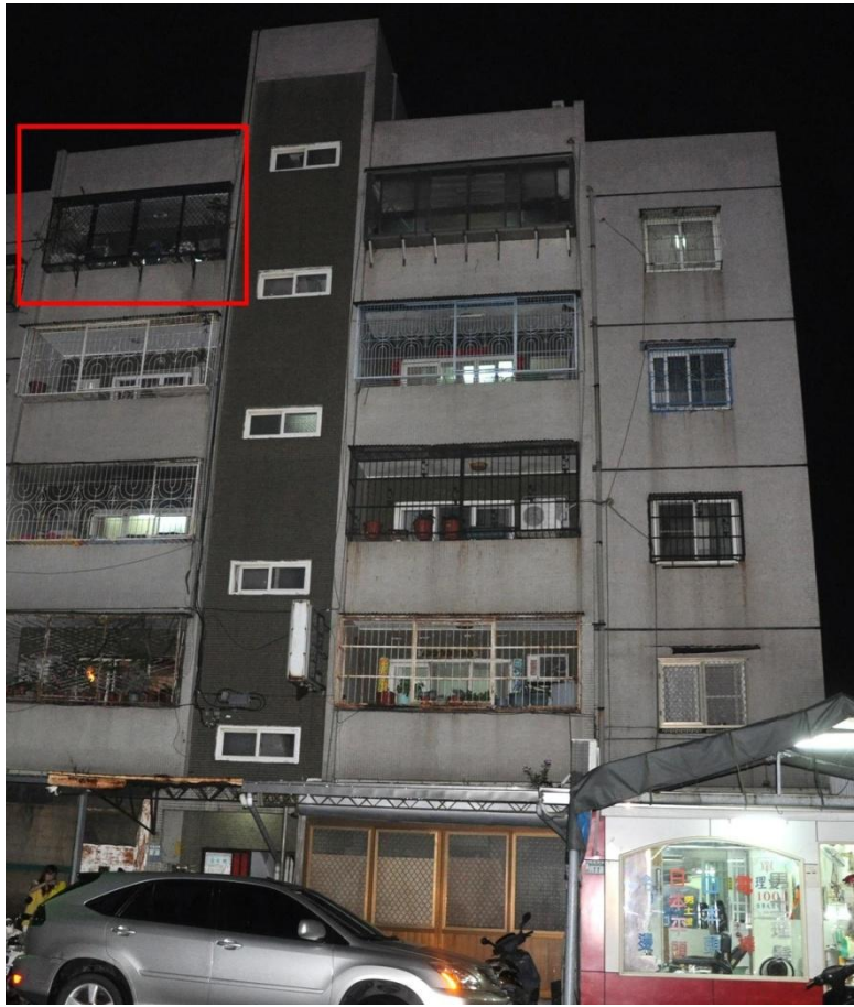
照片 1 建築物外觀受燒情形
