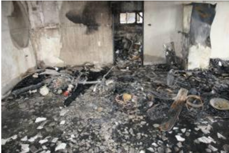
照片 2 室內受燒情形
