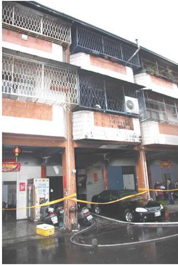
照片 1 建築物外觀受燒情形
