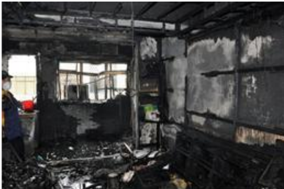
照片 2 室內受燒情形
