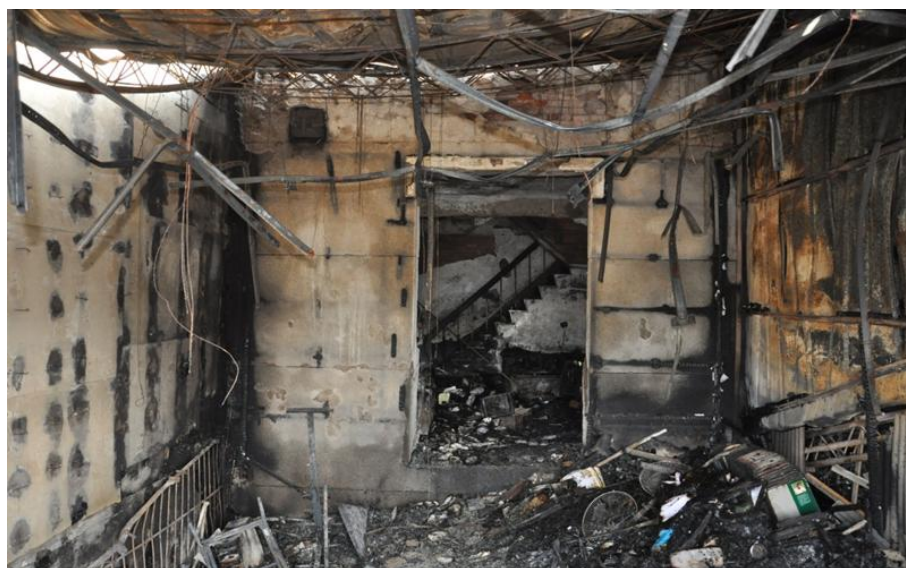
照片 2 室內受燒情形
