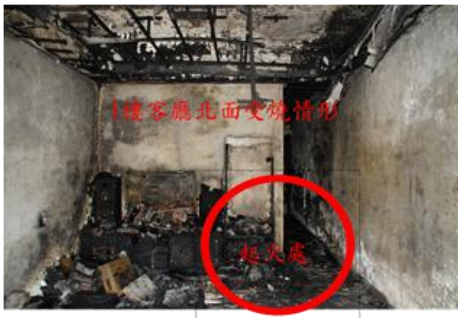
照片 2 室內受燒情形
