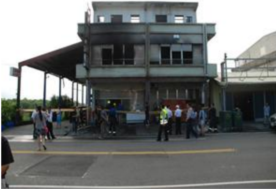
照片 1 建築物外觀受燒情形
