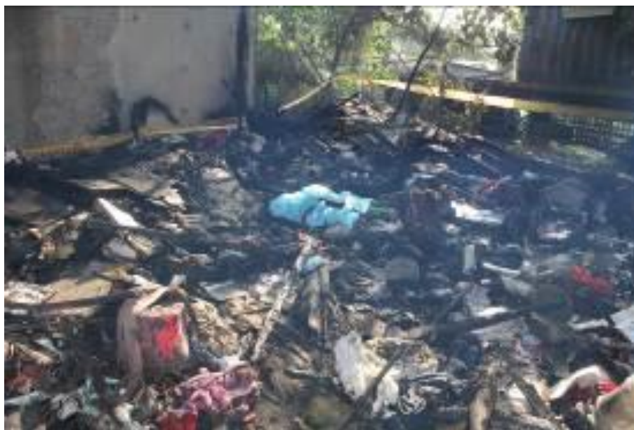
照片 2 室內受燒情形
