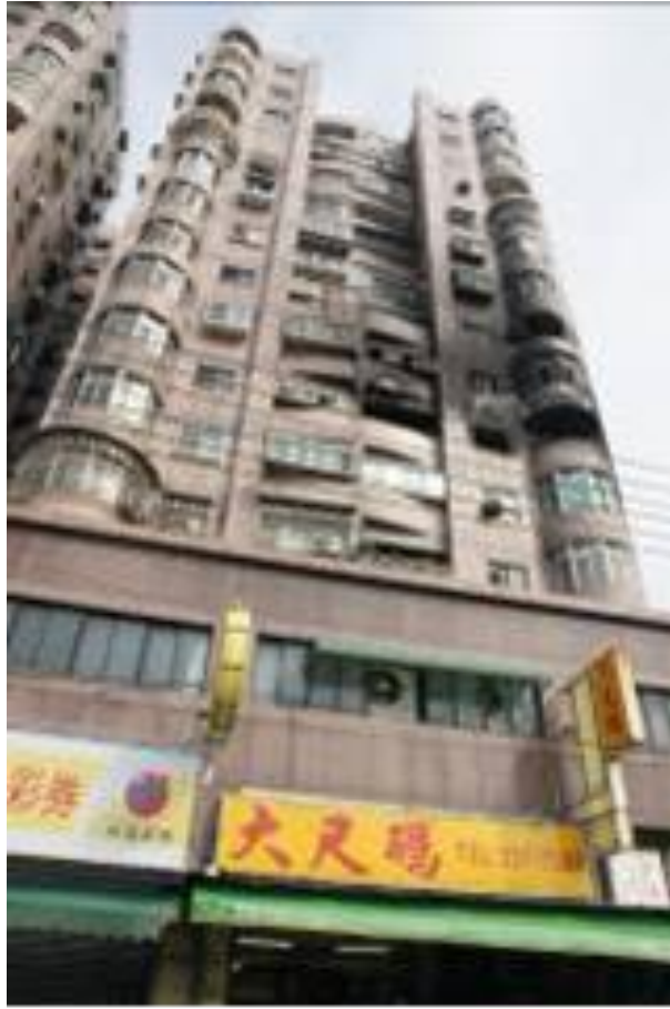
照片 1 建築物外觀受燒情形
