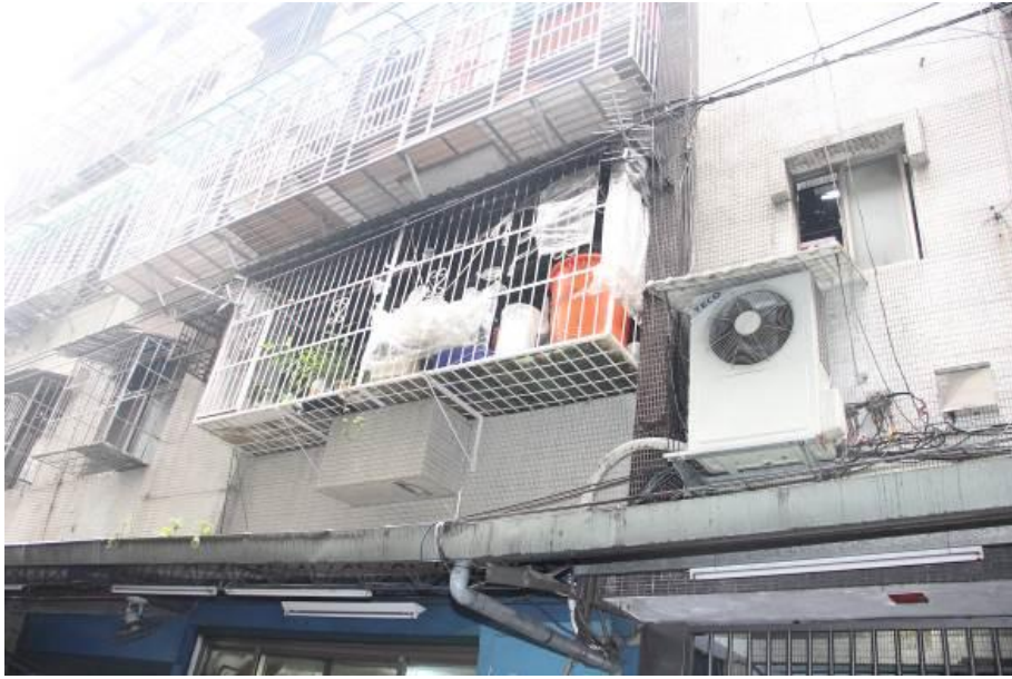
照片 1 建築物外觀受燒情形
