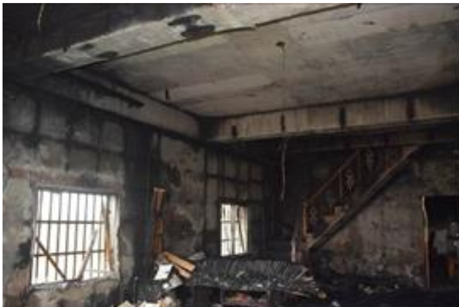
照片 2 室內受燒情形
