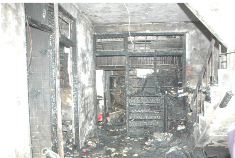
照片 2 室內受燒情形
