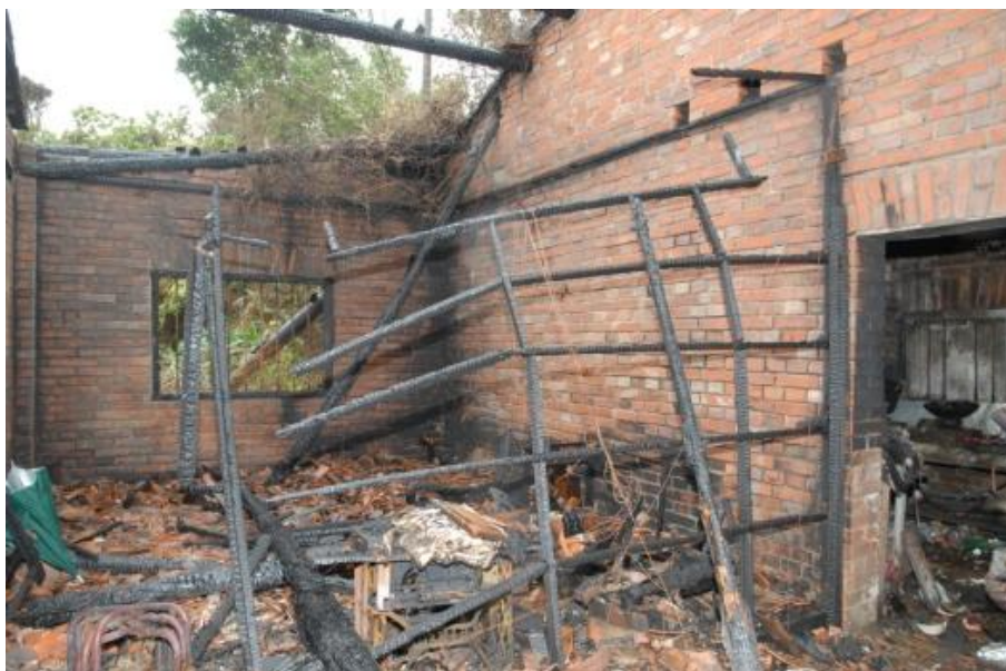
照片 2 室內受燒情形
