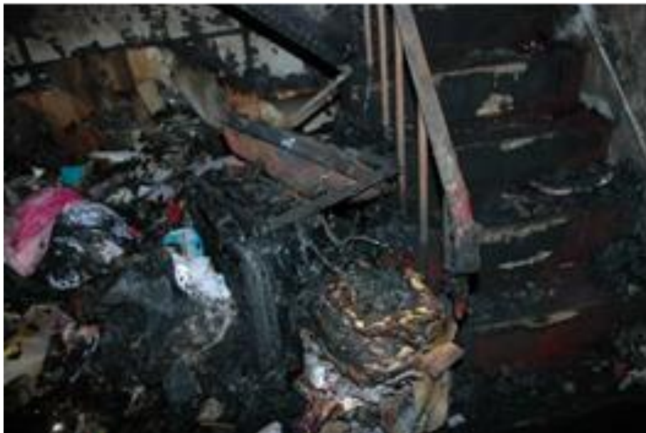
照片 2 室內受燒情形
