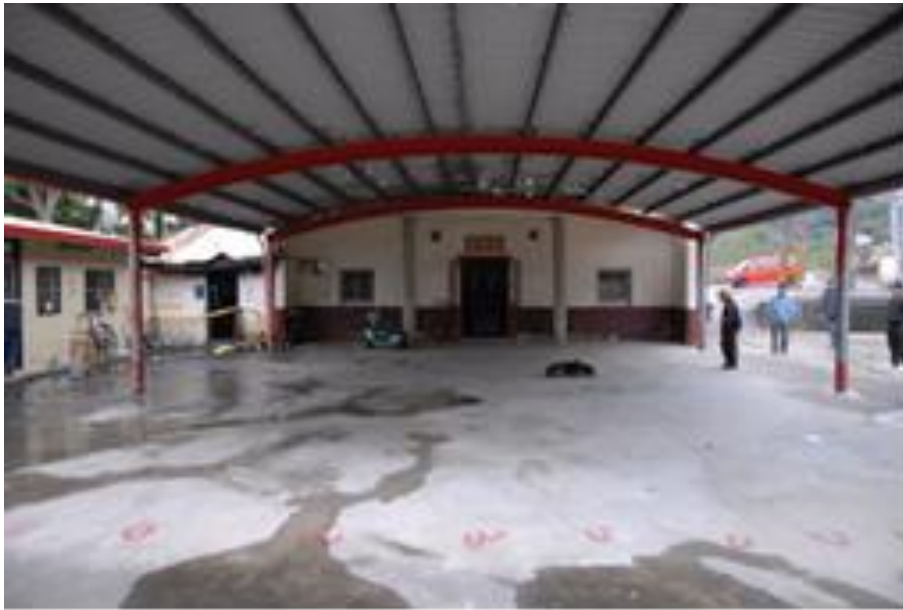
照片 1 建築物外觀受燒情形
