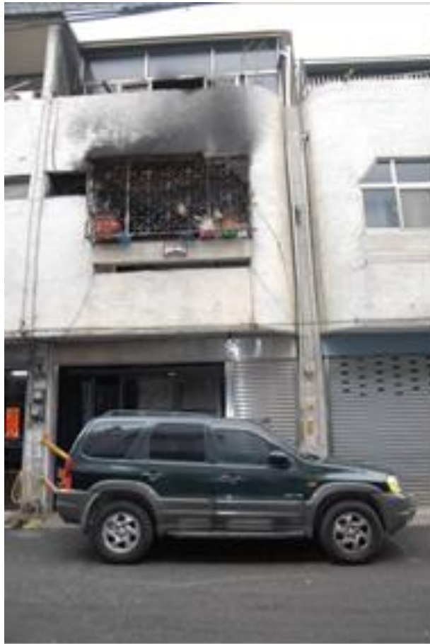
照片 1 建築物外觀受燒情形
