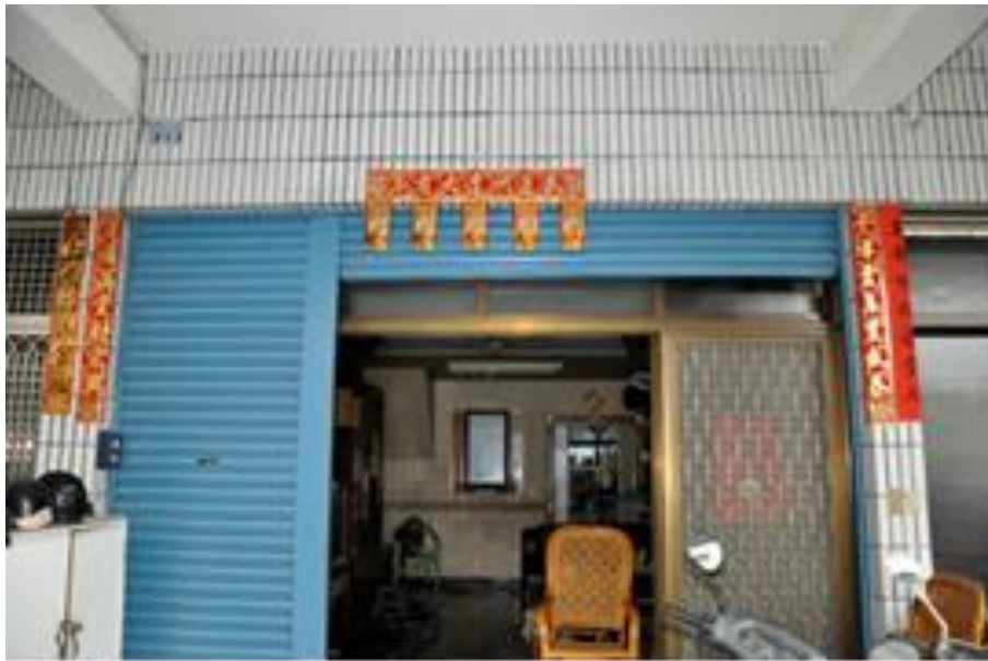
照片 1 建築物外觀受燒情形
