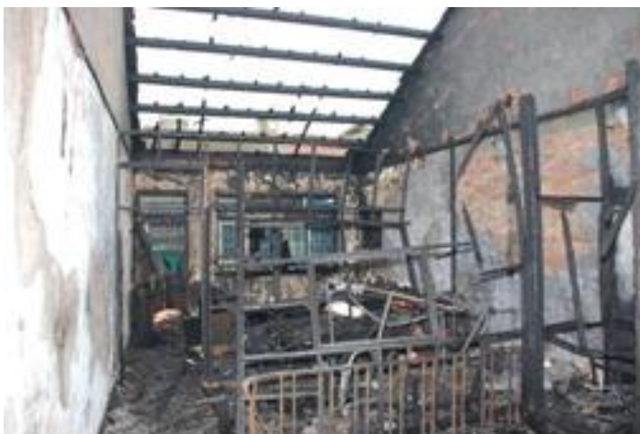
照片 2 室內受燒情形
