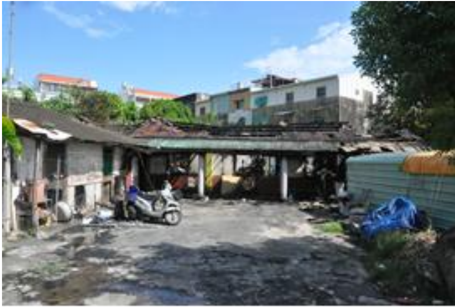
照片 1 建築物外觀受燒情形
