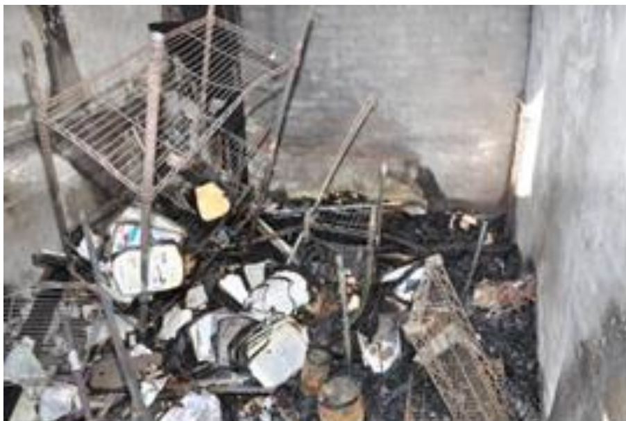
照片 2 室內受燒情形
