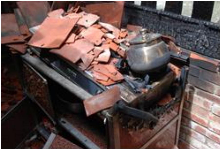
照片 2 室內受燒情形
