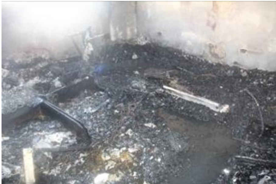
照片 2 室內受燒情形
