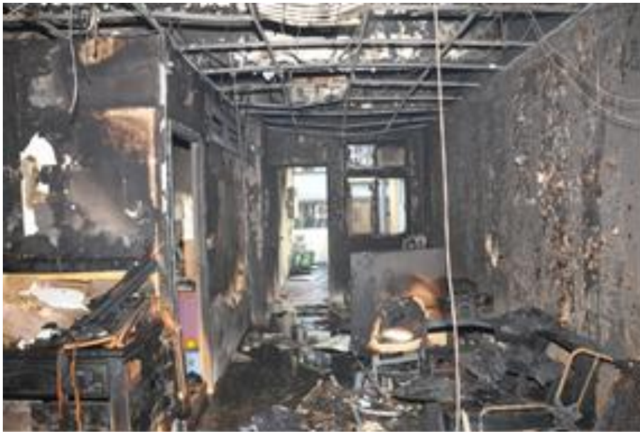
照片 2 室內受燒情形
