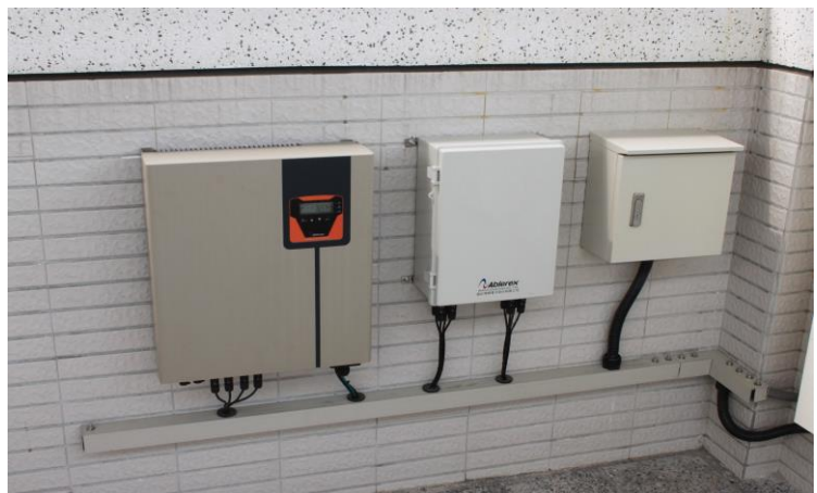
圖 4 左一為變流器（Inverter）
