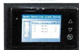
煙霧偵測主機
