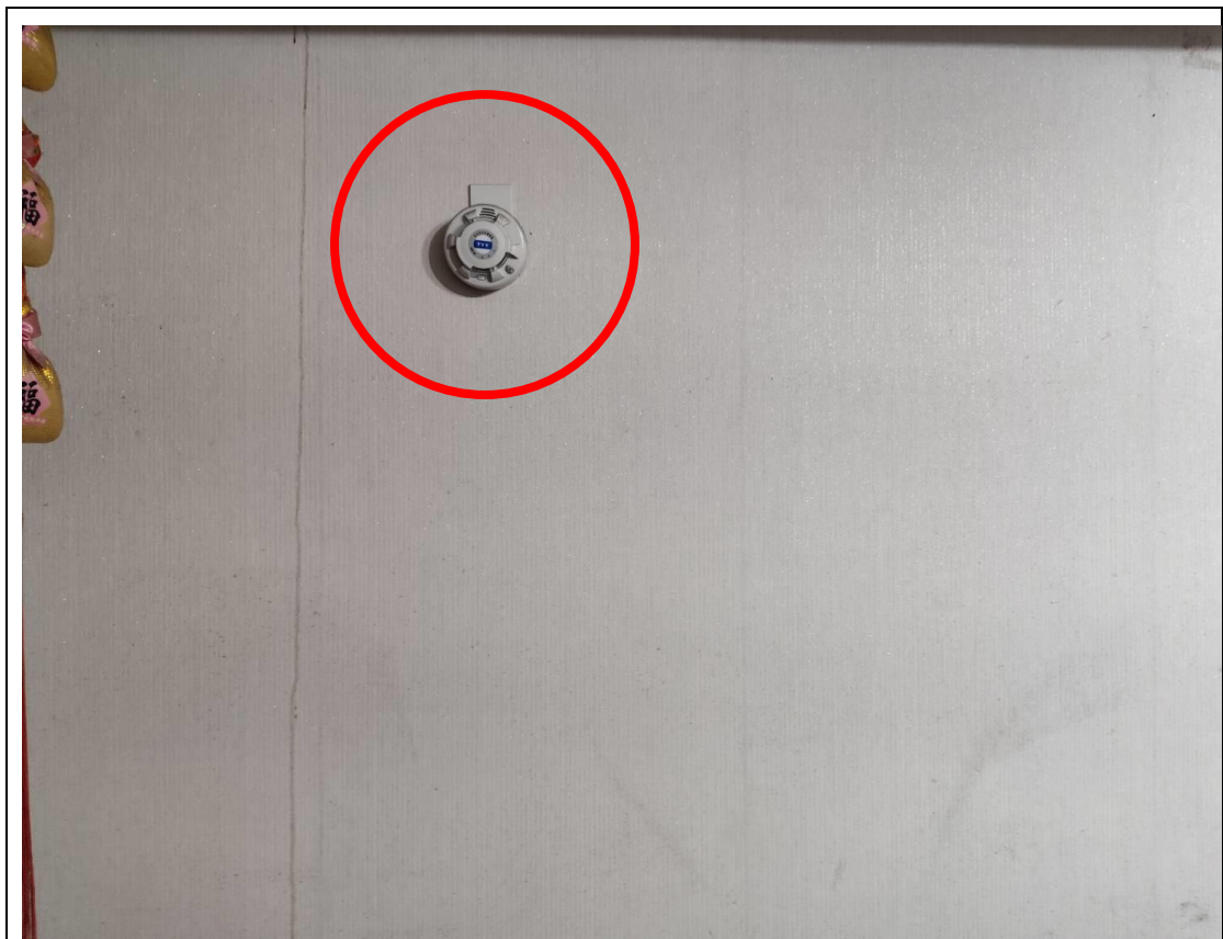
圖三：住警器動作情形及安裝位置(客廳牆上)
