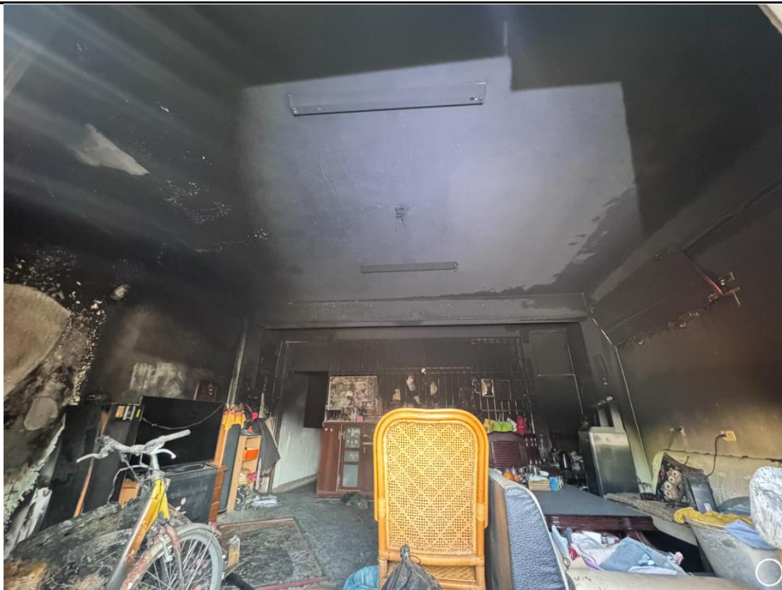
說明：一樓客廳(左側疑似起火處)
