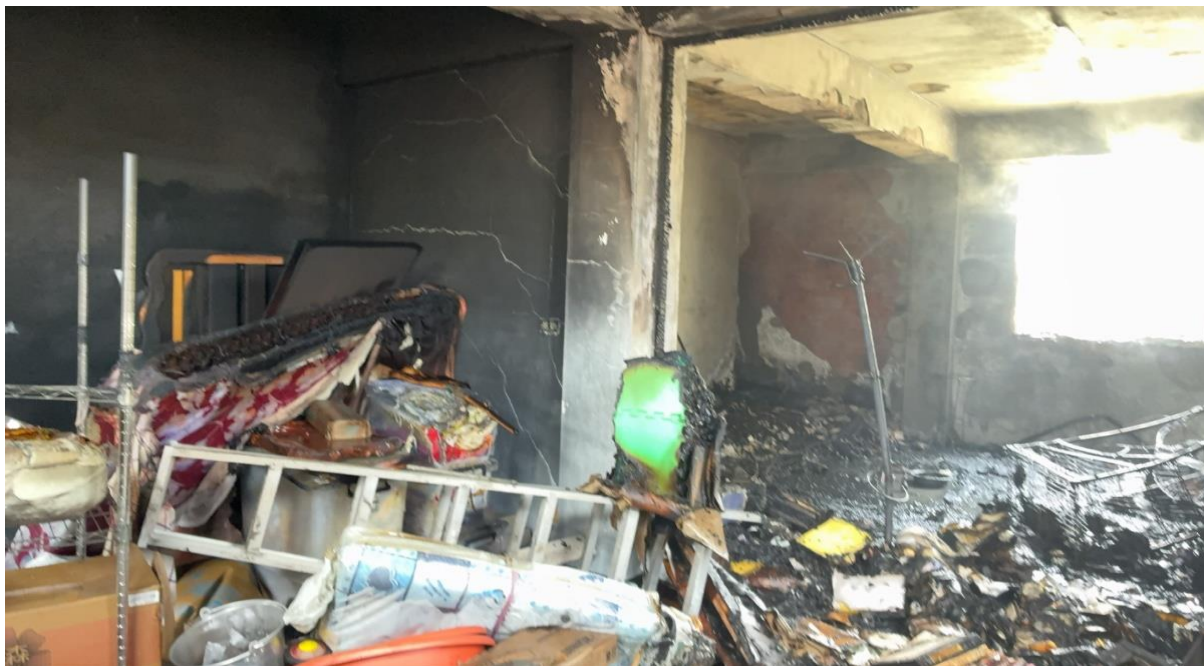
說明：四樓臥室起火處燒損情形。
