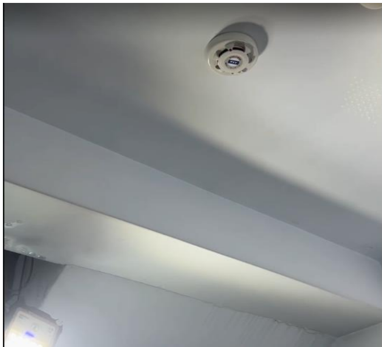
說明：住警器安裝位置(三樓樓梯口)。
