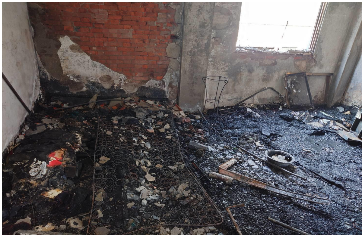
說明：四樓臥室起火處燒損情形。
