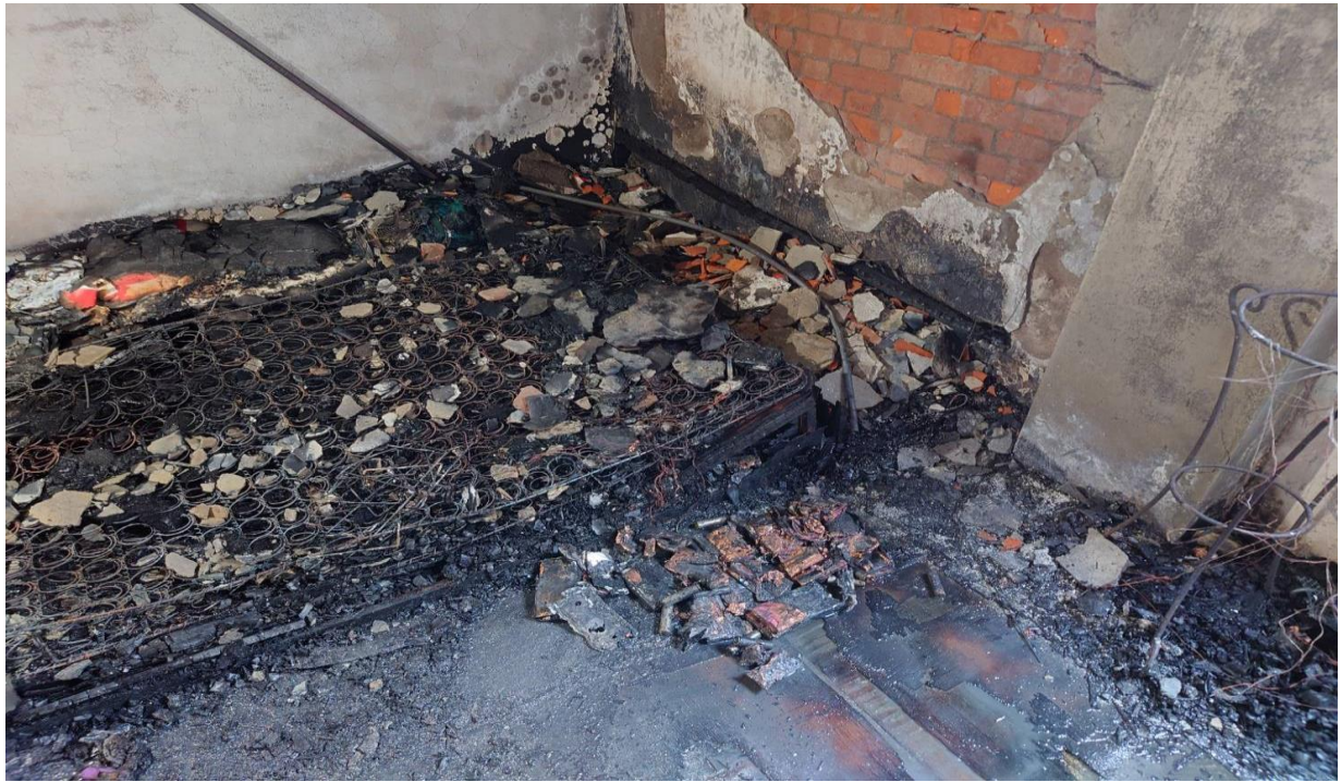
說明：四樓臥室起火處燒損情形。
