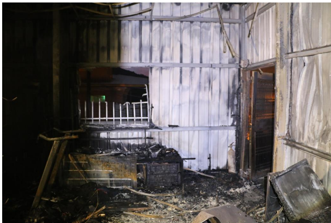
說明：三樓起火樓層(疑似起火處)
