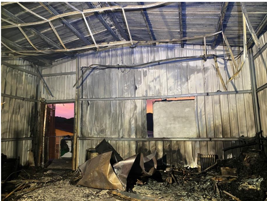
說明： 3樓起火樓層西側牆面受燒情形(由東向西拍攝)
