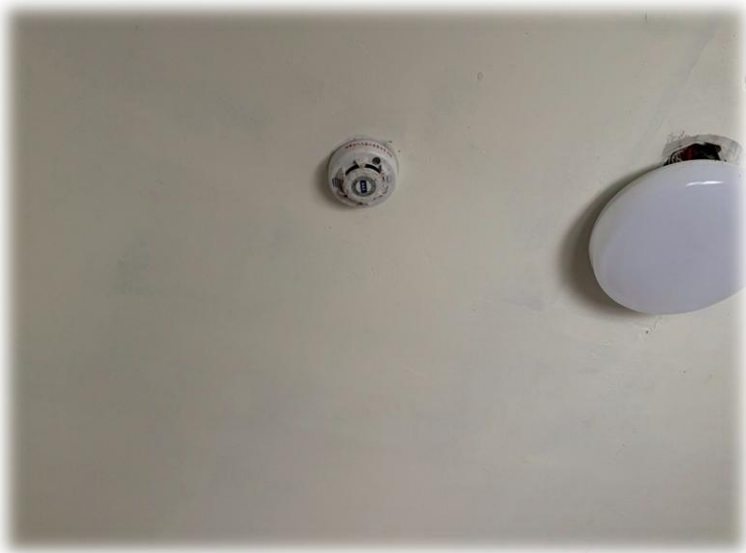
住警器裝設於一樓客廳天花板上
