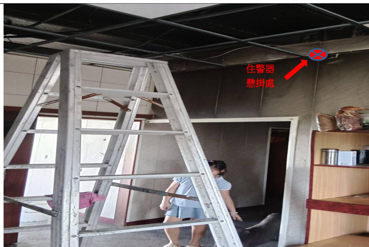
1樓廚房走道住警器裝設位置照片
