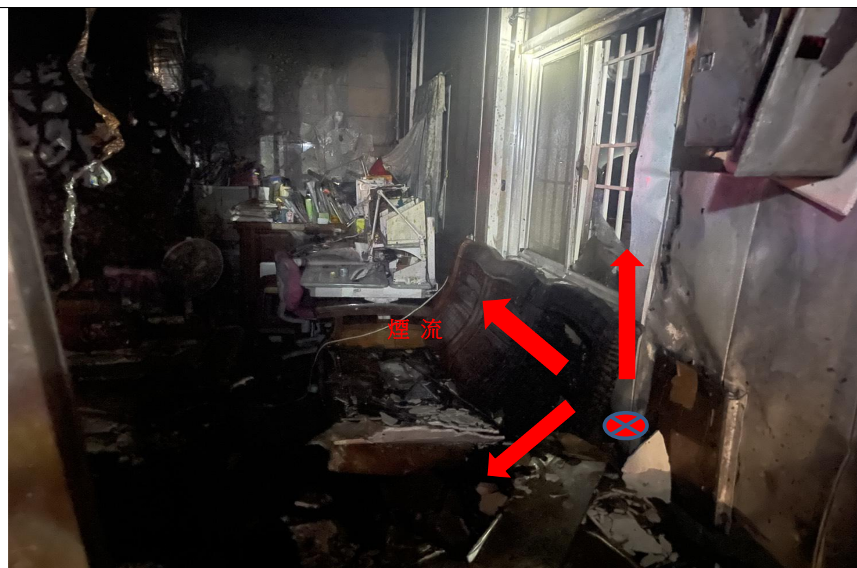
1樓客廳燃燒及煙流照片
