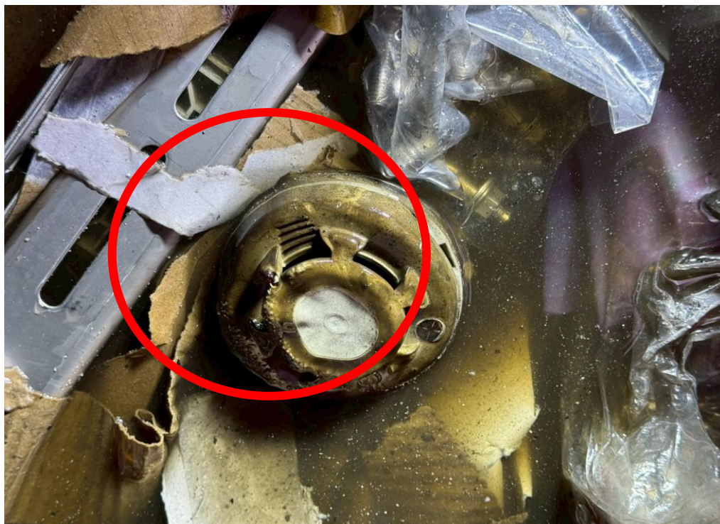
說明：住警器安裝位置(1樓廚房天花板(住警器因黏貼處燒熔掉落))
