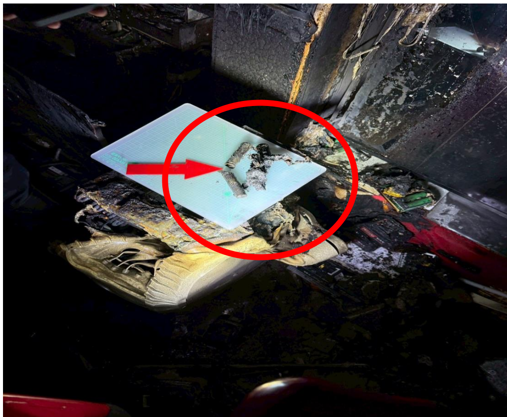
說明：1樓店面北側移動式冷氣機上方電動起子鋰電池(起火處)。
