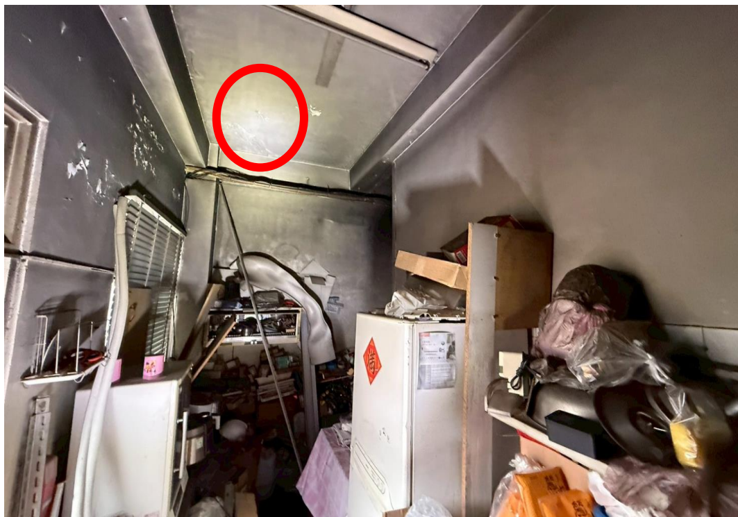
說明：住警器安裝位置(1樓廚房天花板(住警器因黏貼處燒熔掉落))。
