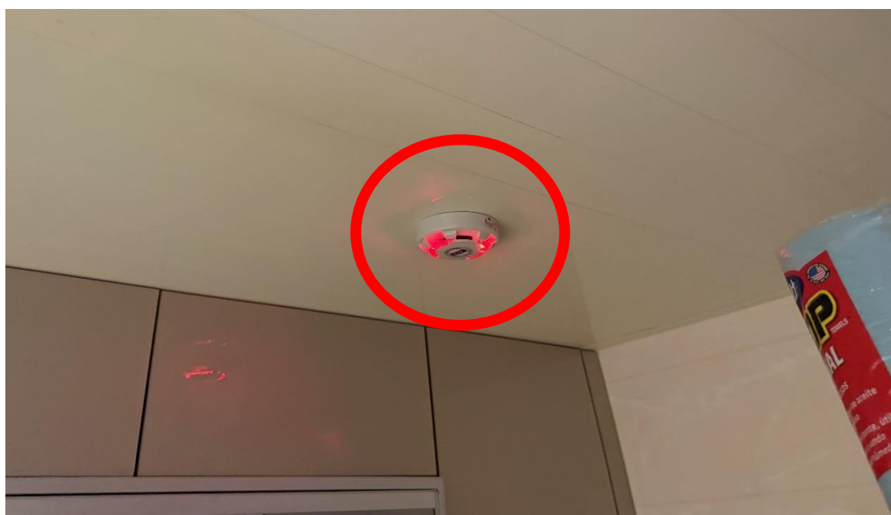
圖三：住警器動作情形及安裝位置(廚房天花板上)
