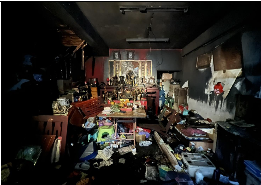
說明：起火住戶受燒情形(一樓大廳為住宅式宮廟)。
