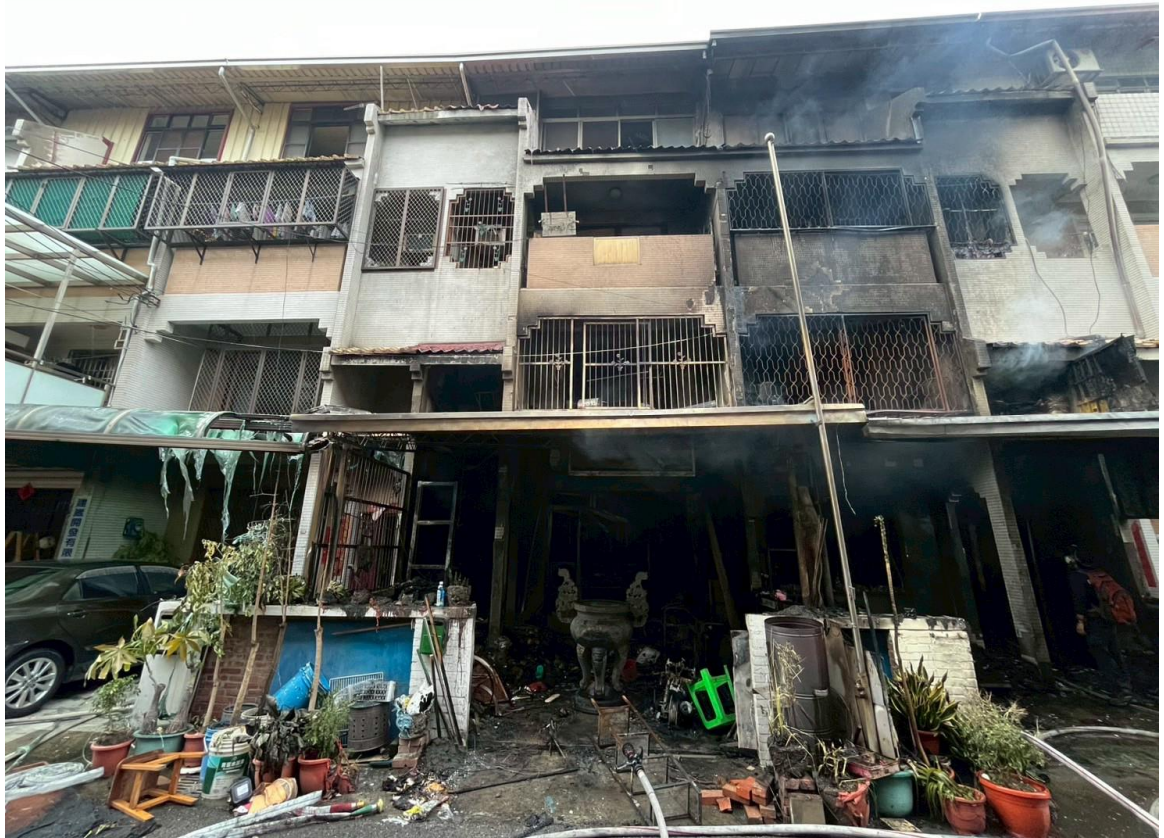
說明：起火建築物○號為地上 3 層樓，RC 構造 4 樓鐵皮加蓋，一樓為住宅式宮廟，並延燒 號之情形。
