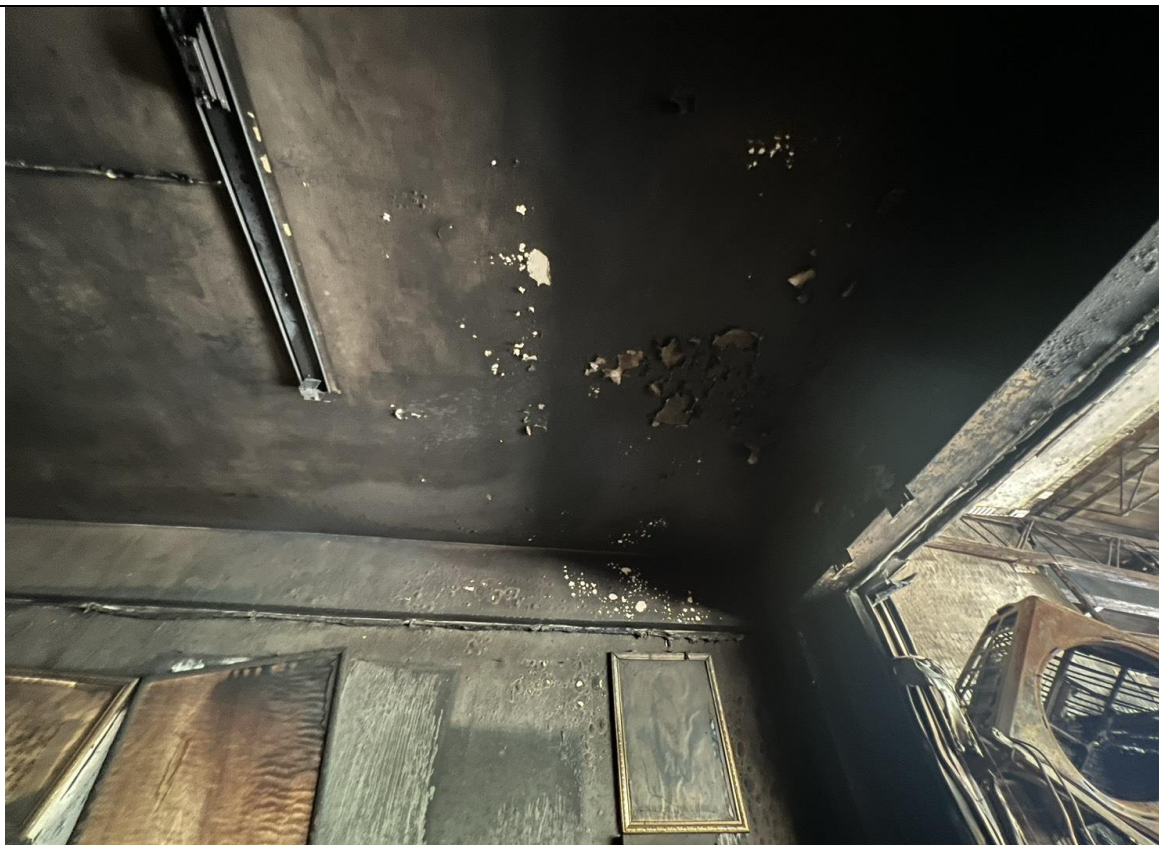
說明：住警器安裝於一樓客廳，但因受燒嚴重，已掉落至地板。
