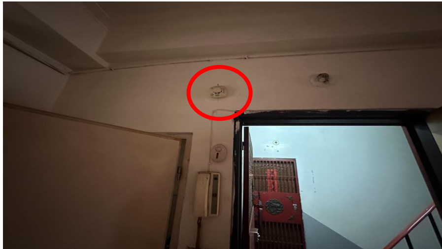
圖三：住警器安裝位置(客廳牆上)
