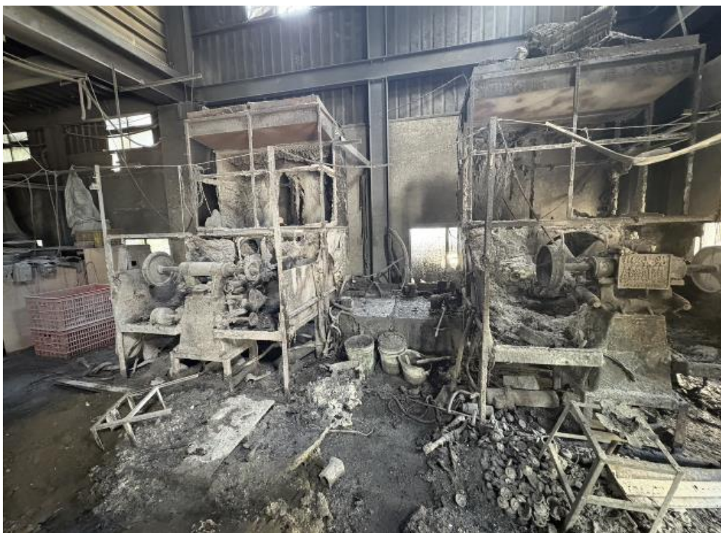
說明：一樓作業區起火處燒損情形。
