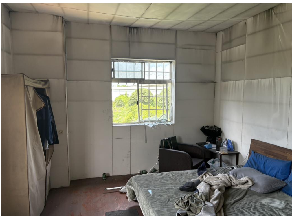
說明：二樓房間煙燻情形(有關門)。
