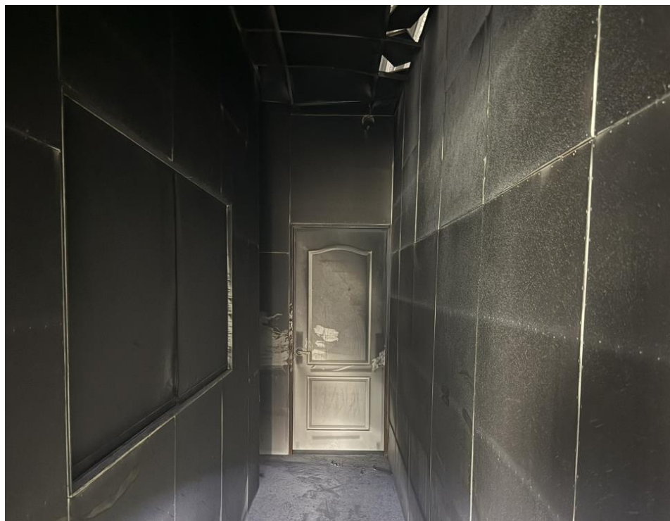
說明：二樓走廊煙燻情形。
