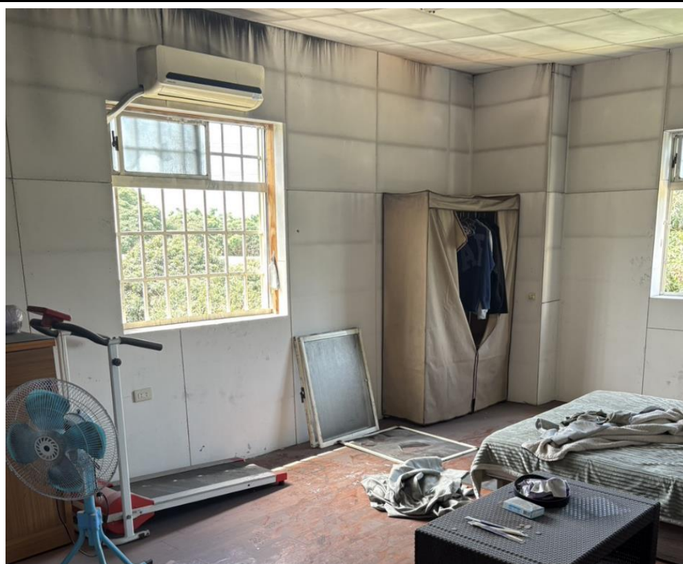
說明：二樓房間煙燻情形(有關門)。
