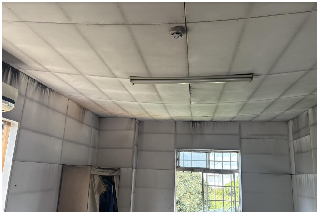
說明：住警器安裝位置(二樓房間)。
