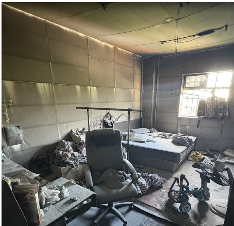
說明：二樓房間煙燻情形(無關門)。
