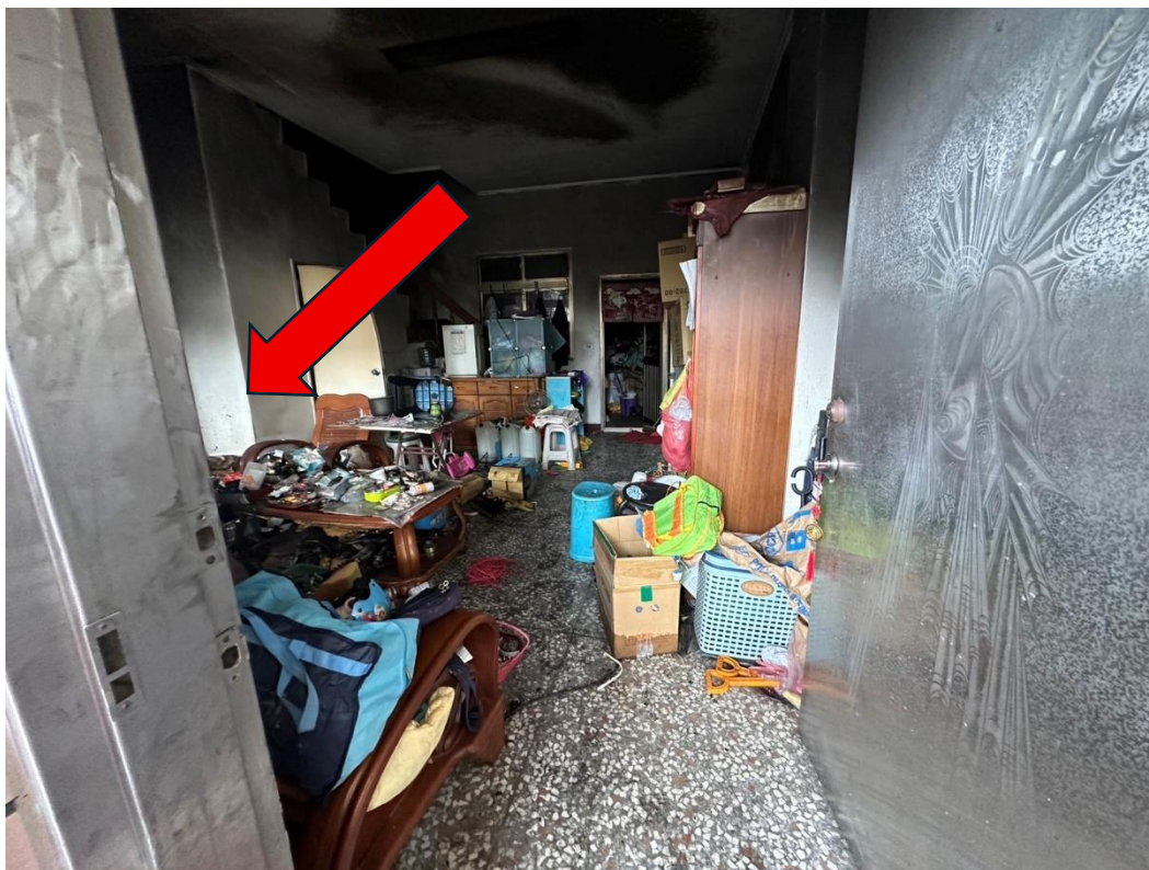
說明：1樓起火處受燒照片。。
