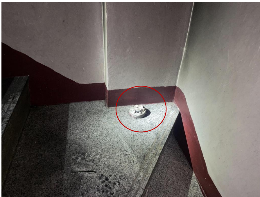
說明：1樓梯間住警器裝設情形(受燒掉落)
