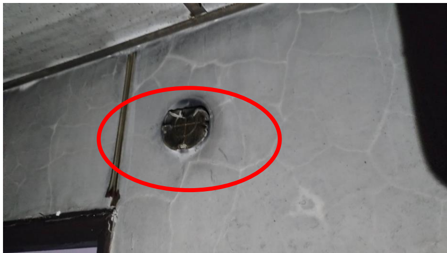
圖三：住警器安裝位置(走廊牆上)
