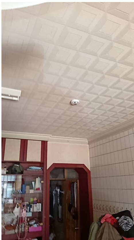
說明：一樓住警器裝設情形
