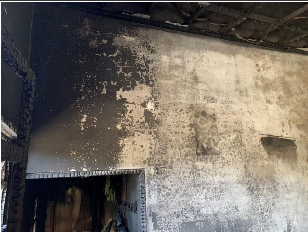
說明：住警器安裝位置(客廳牆壁)
