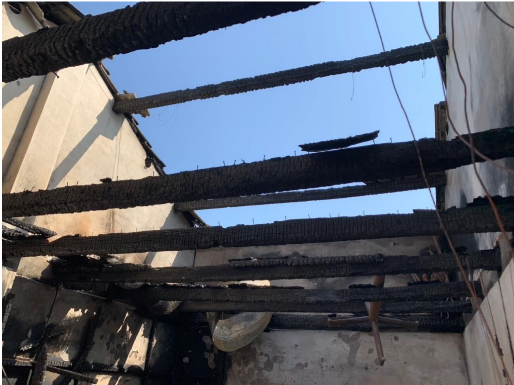
說明：一樓客房天花板(疑似起火處)
