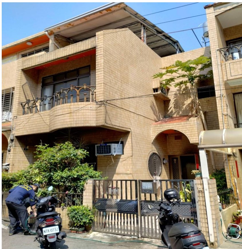
說明：起火建築外觀為地上2層樓，RC構造透天住宅
