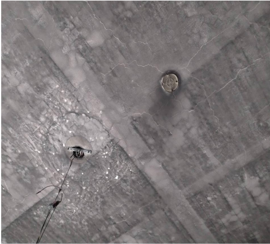
說明：住警器原安裝於客廳天花板
