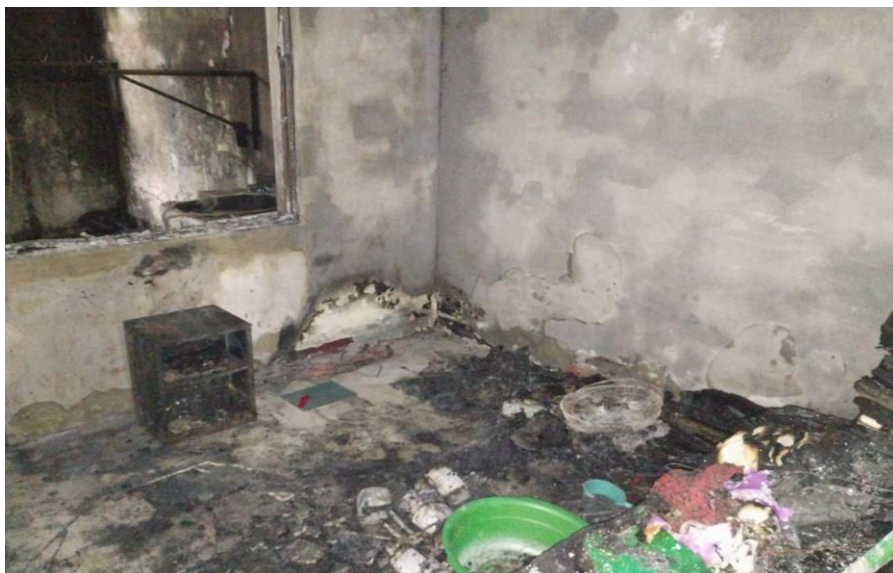
說明：起火住戶受燒情形(一樓書房)
