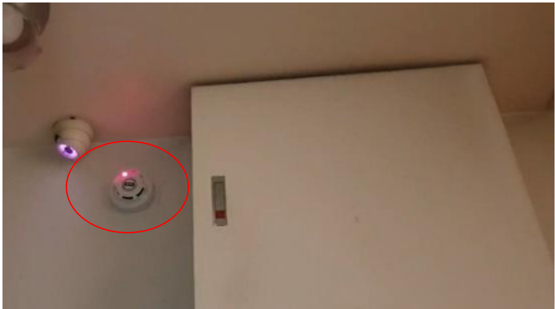
圖三：住警器安裝位置(走廊牆壁上)
