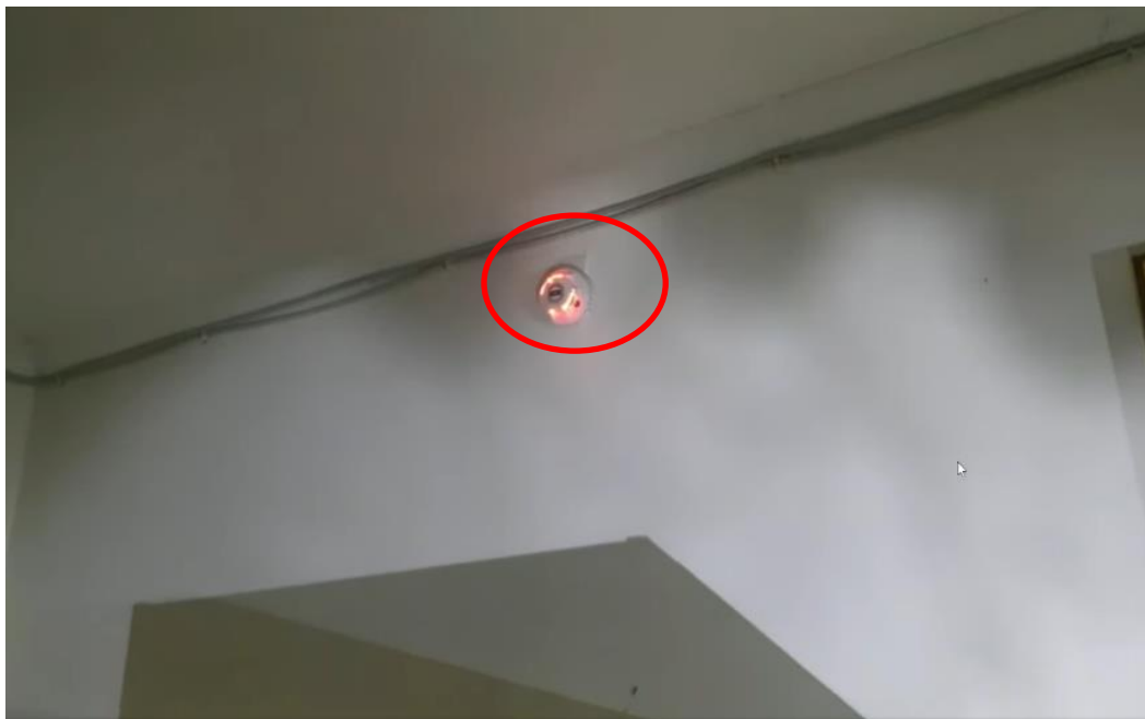
圖 2：住警器安裝位置及動作情形
