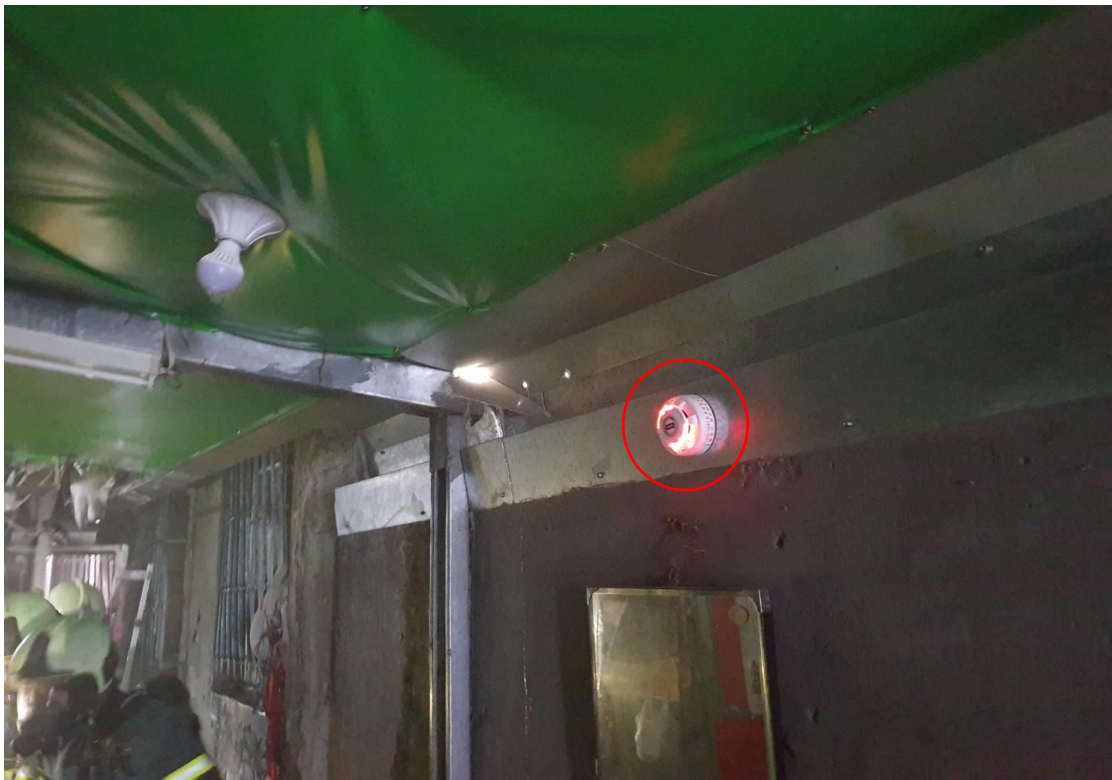
圖三：住警器安裝位置(走廊牆上)
