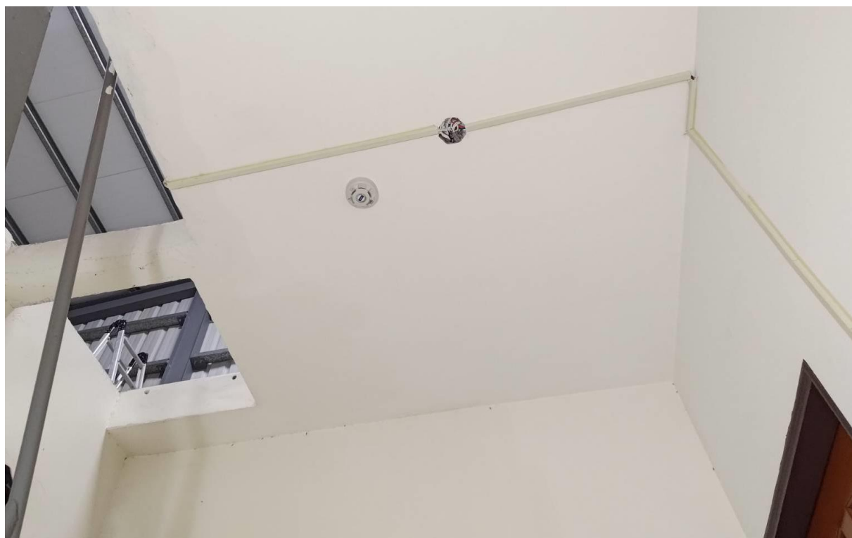
說明：住警器安裝位置(四樓梯間)
