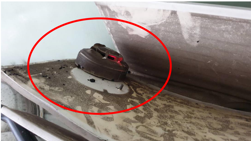
圖二：住警器動作情形(住警器因燒毀掉落)
