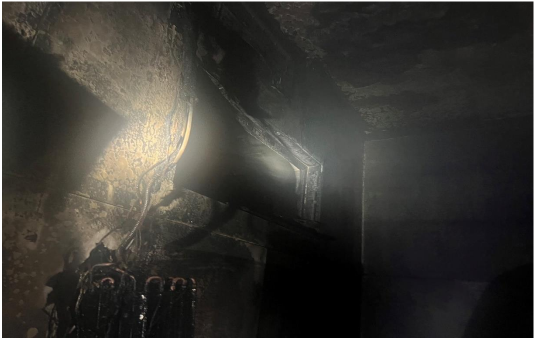
圖一：起火處(臥室)
