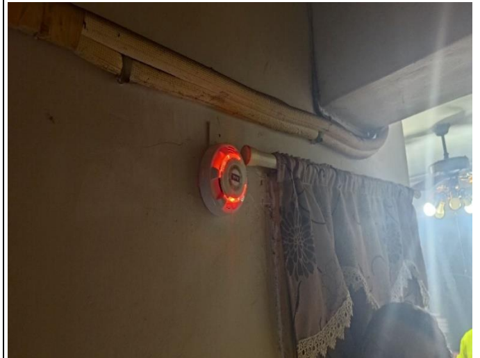
圖片說明：住警器安裝位置
