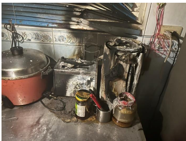
圖片說明：廚房電器櫃上熱水瓶燒熔
