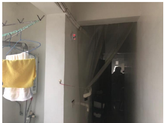
圖片說明：設置於走廊的住警器。
