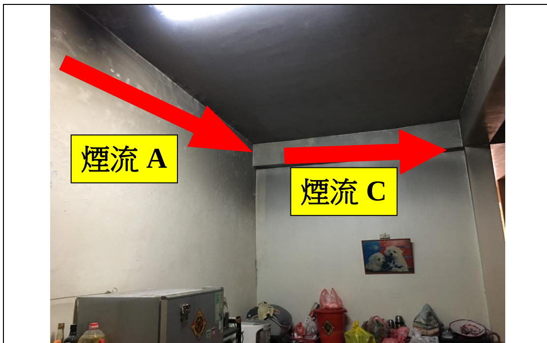
起火樓層/居室煙流照片
