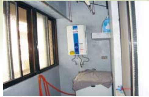
圖4-16-5 熱水器裝設後陽臺達建封閉造成居家一氧化碳中毒潛勢主因
